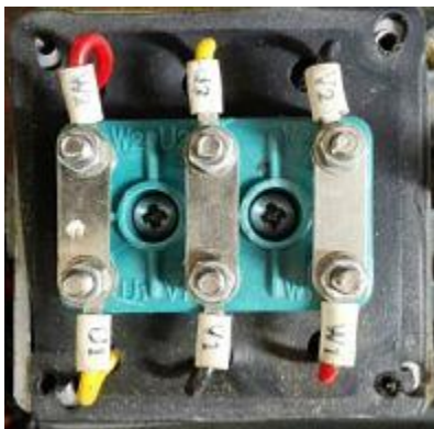
Figura 27: Bornera conexión en delta de un motor de inducción
