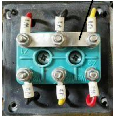
Figura 25: Bornera conexión en estrella de un motor de inducción
