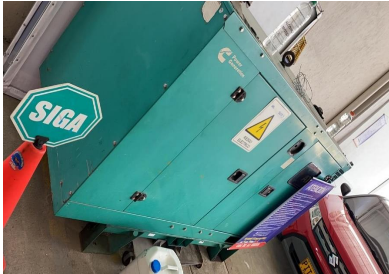
Figura 20 . Consumo planta eléctrica (combustible diesel)
