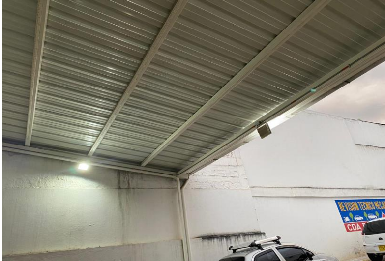
Figura 26 . Reflectores led para iluminación de instalaciones (12 w/unid)
