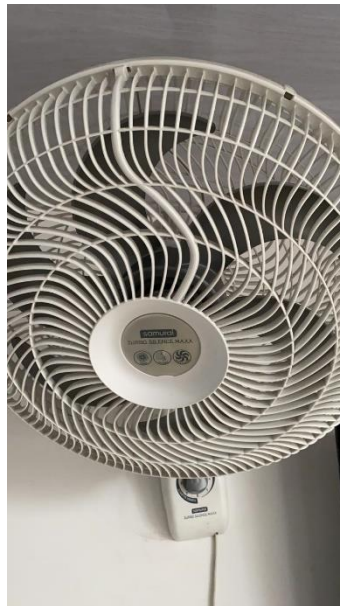
Figura 33 . Ventilación sala de clientes
