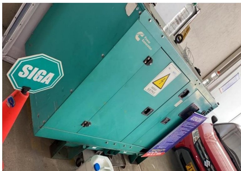
Figura 21 . Consumo planta eléctrica en funcionamiento
