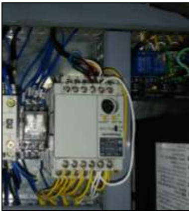
Figura 15 Conexión entre Módulo de 8 Relevos y PLC Fuente: Los autores
