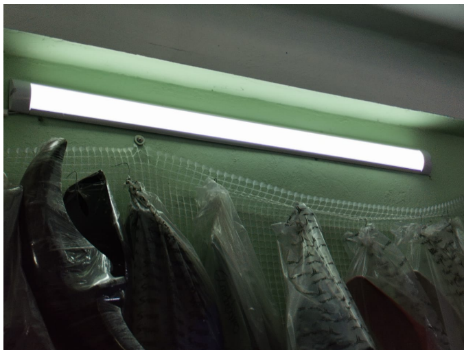
imagen 5. Luminaria parte interna
