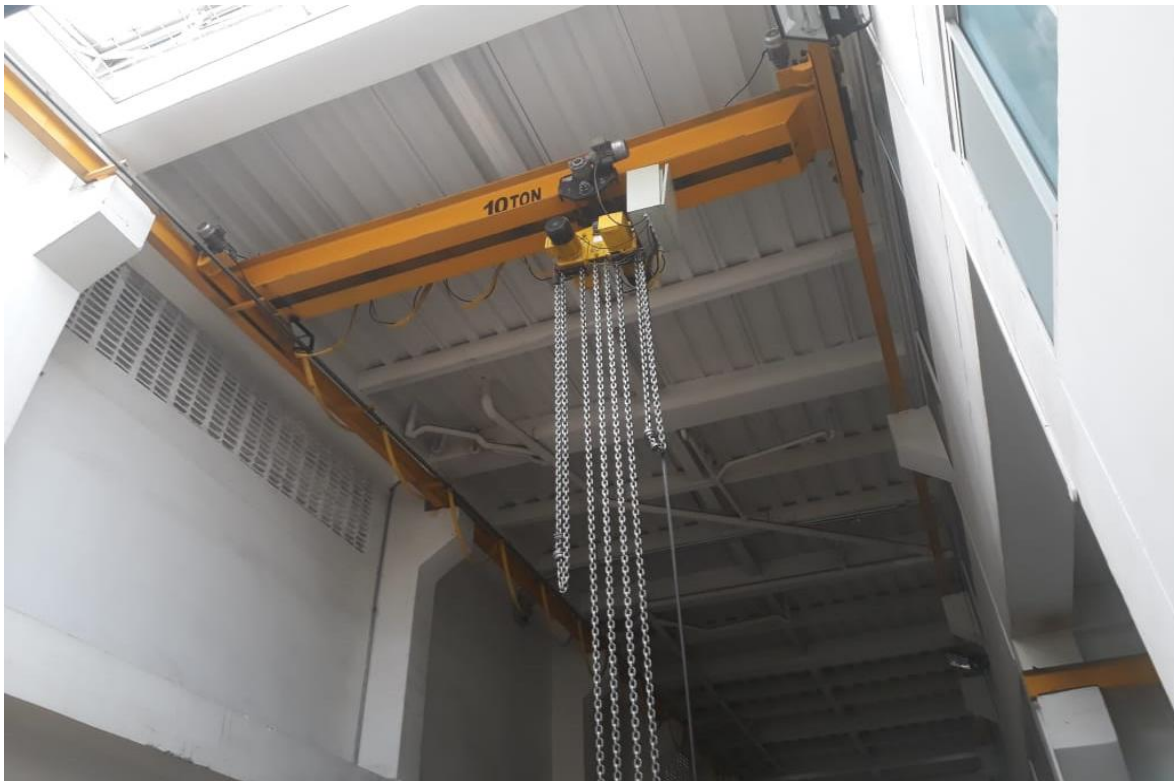
Figura 13. Grúa para el traslado de motores eléctricos
