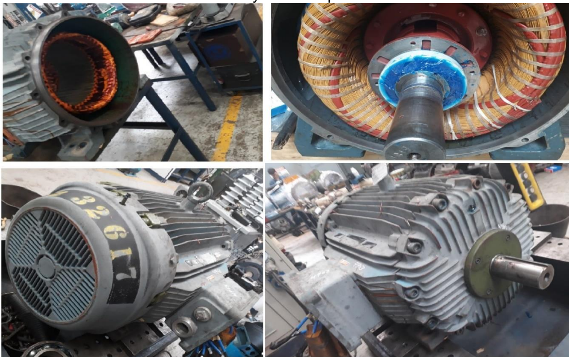
Figura 3. Mantenimiento preventivo, condición del motor presenta desbalance de corrientes y altas temperaturas
