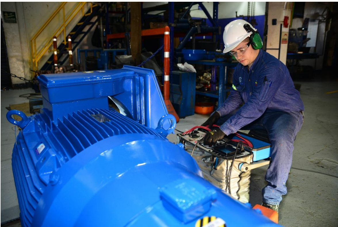
Figura 4. Mantenimiento preventivo bajo aislamiento, cambio de RTD
