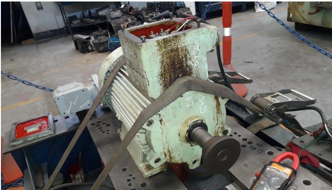
Figura 2. Mantenimiento preventivo, condición del motor presenta vibraciones
