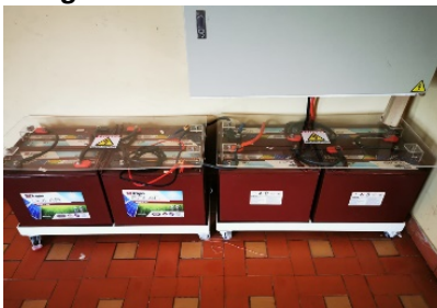
Figura 24. Banco de baterías
