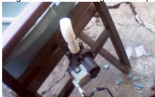
Figura 45. Bomba de Agua de ½ hp
