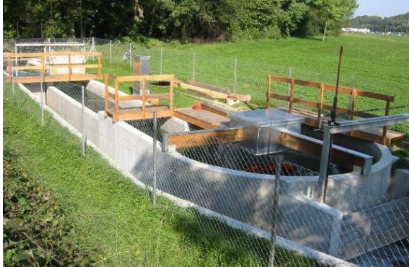
Figura 1. Vista panorámica planta de generación mediante vortex en funcionamiento
