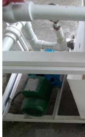
figura 60. Bomba y tubería
