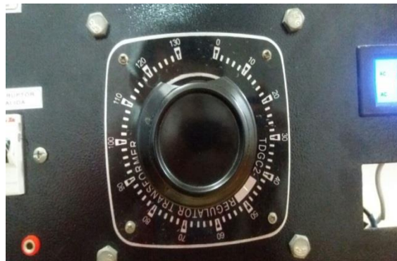
Imagen 35, parte frontal Transformador 37
