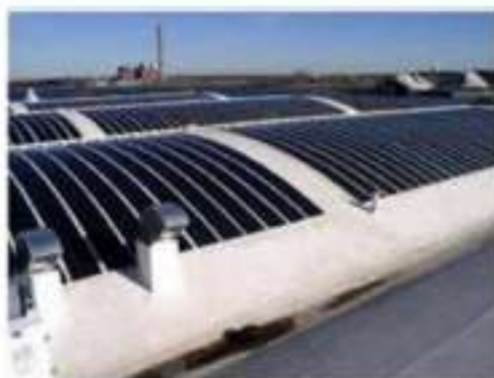
Figura 8. Módulo fotovoltaico adherido a un techo tipo TPO.
