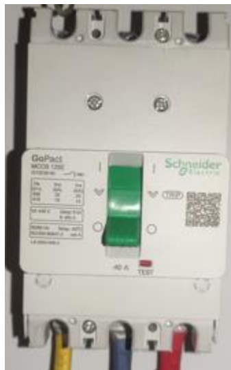
Interruptor Totalizador (QT01)
