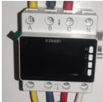
Medidor Multifunción trifásico (ME01)
