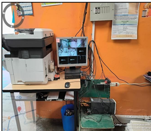
Figura 34. Cableado eléctrico expuesto en la biblioteca
