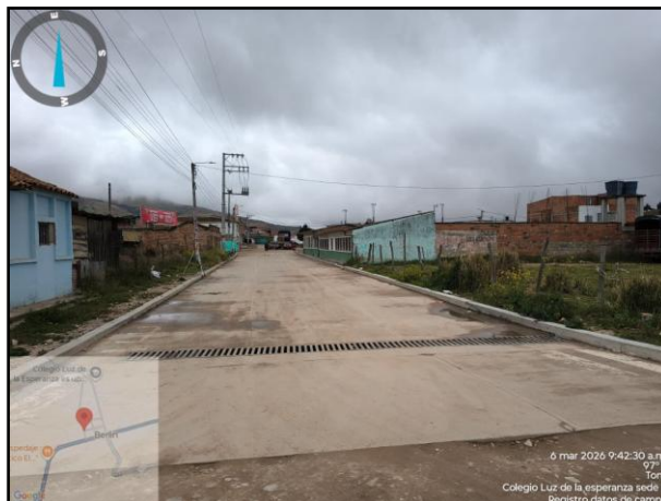
Figura 39. Falta de señalización vial
