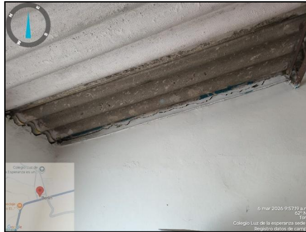
Figura 30. Riesgo de colapso del techo por fracturas en tejas
