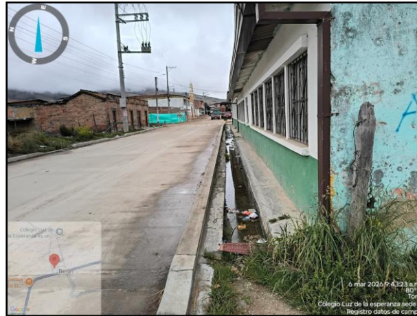
Figura 36. Deficiencia en la evacuación de aguas lluvias
