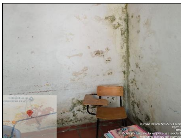
Figura 32. Presencia de humedad en paredes internas
