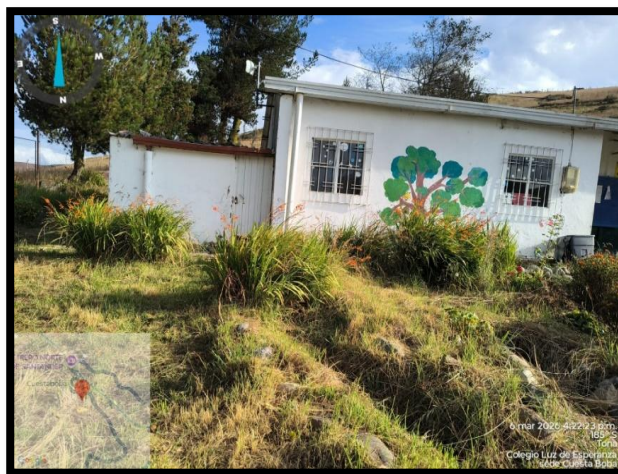
Figura 44. Obstrucción en áreas de circulación por hundimientos de terreno
