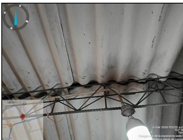
Figura 29. Riesgo de colapso del techo por falta de anclajes
