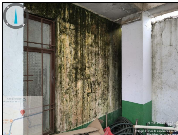
Figura 31. Presencia de humedad en paredes externas
