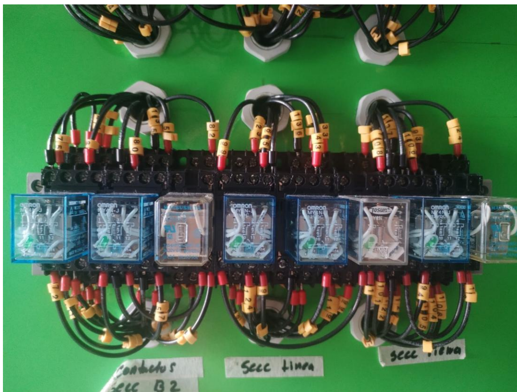
Figura 13. Relés auxiliares utilizados para la implementación de la lógica de control y los enclavamientos operativos del banco de simulación.
