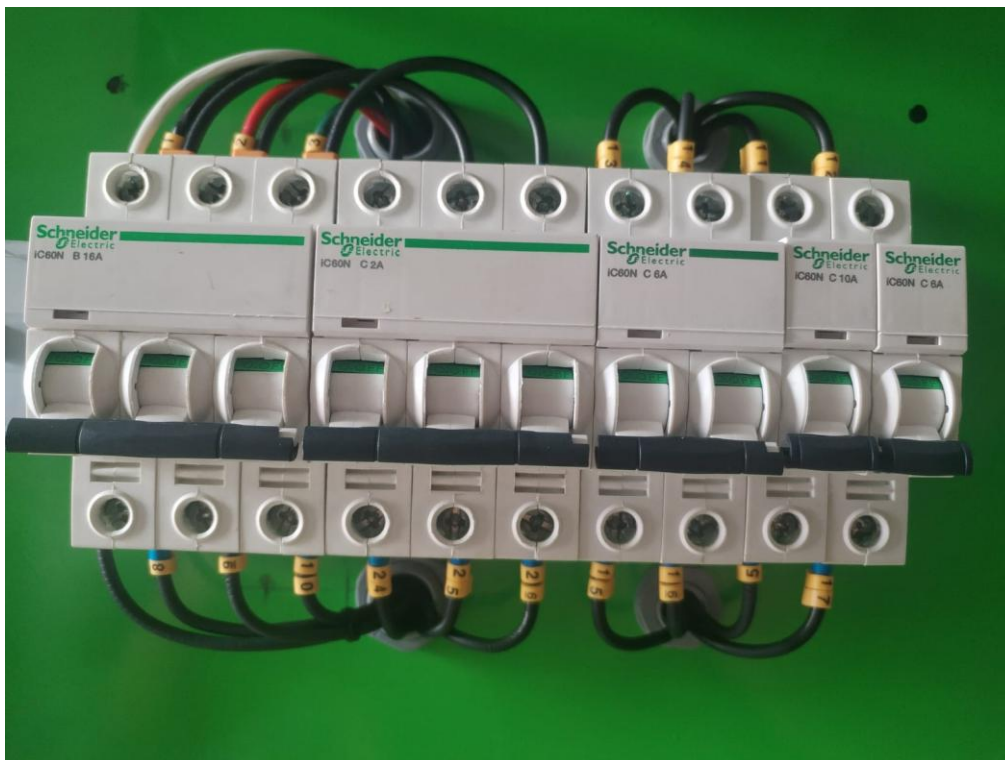
Figura 14. Sistema de protección eléctrica implementado mediante interruptores termomagnéticos para los circuitos de alimentación y control.
