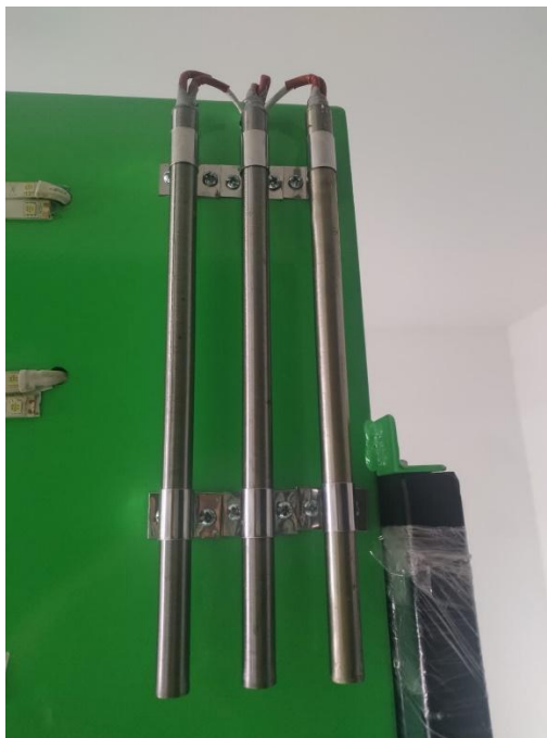
Figura 12. Sistema de barras trifásicas integrado al circuito eléctrico del banco de simulación de la bahía de subestación.
