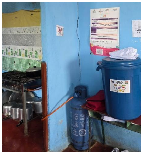
Figura 19. Ubicación de tanque de gas
