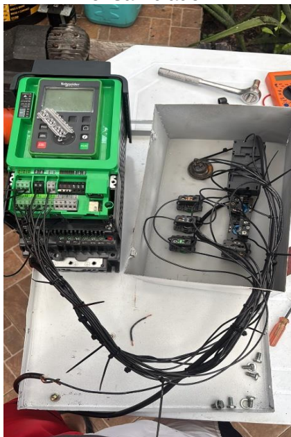
Ilustración 9 Vista interna del gabinete eléctrico con el sistema eléctrico y de control ensamblado.
