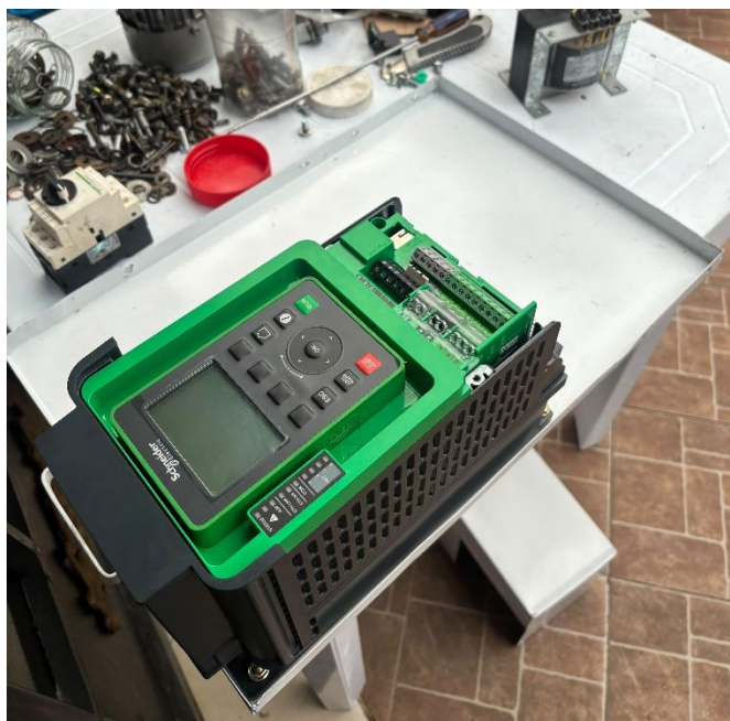
Ilustración 7 Variador de velocidad Schneider Electric Altivar ATV930U07M3
