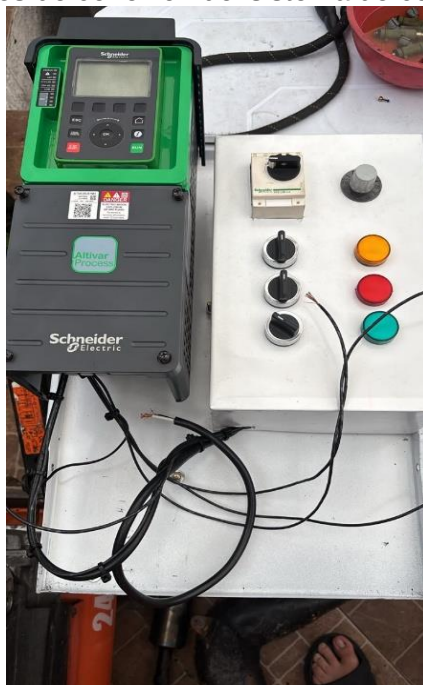
Ilustración 10 Vista frontal del panel eléctrico con los elementos demanda, señalización y puntos de conexión del sistema de control.
