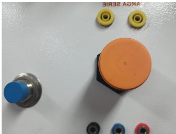
Figura 29 Montaje sensores inductivos 2 y 3 hilos módulo de accionamientos
