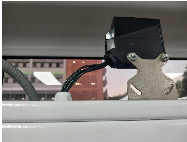
Figura 28 Montaje sensores fotoeléctrico módulo de accionamientos
