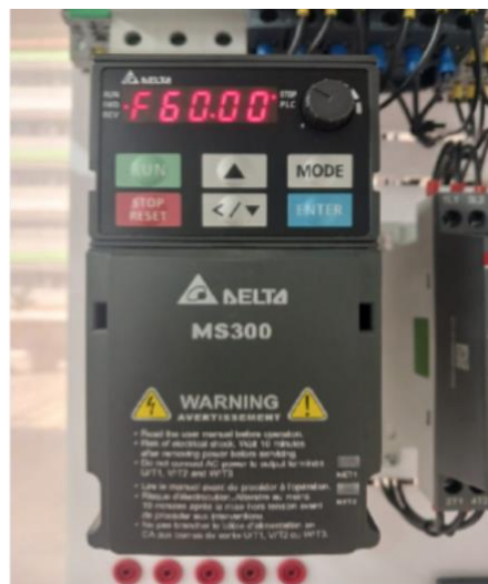
Figura 36 Visualización tablero Convertidor de frecuencia DELTA
