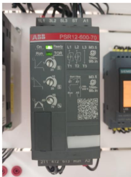
Figura 35 Visualización tablero Arrancador suave ABB
