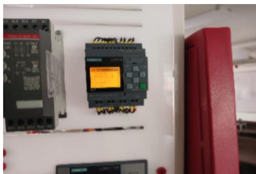
Figura 33 Visualización tablero logo V8 modulo accionamientos eléctricos
