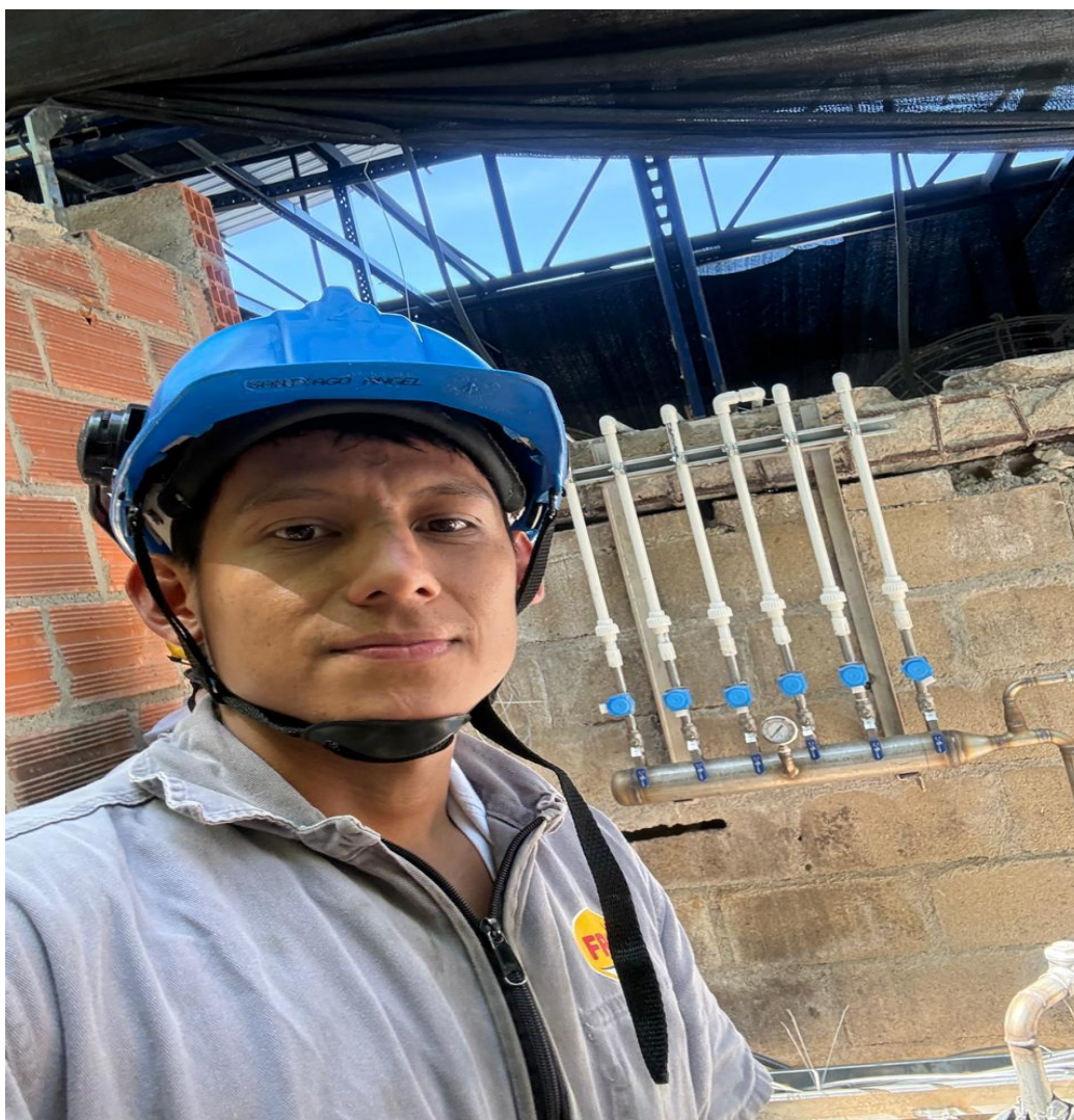
Figura 30 electroválvulas y distribución de tubería del sistema de aspersión.
