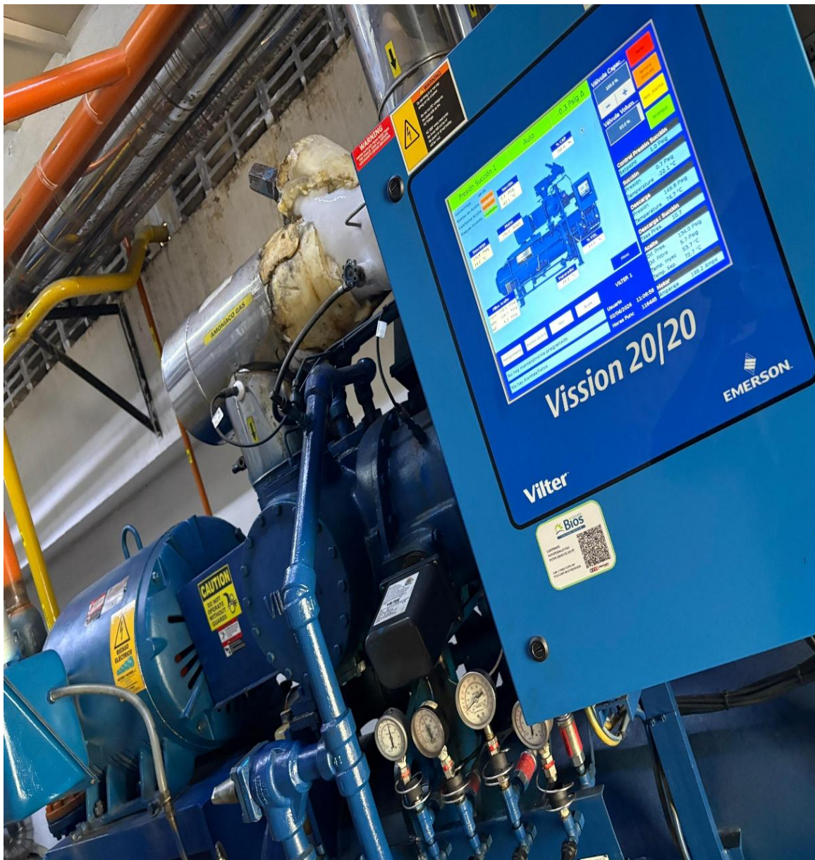
Figura 3 compresor vilter del sistema refrigeración para túneles y conserva
