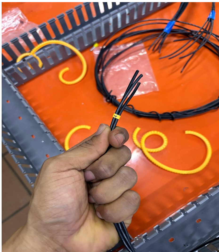
Figura 22 Marcado de conductores.
