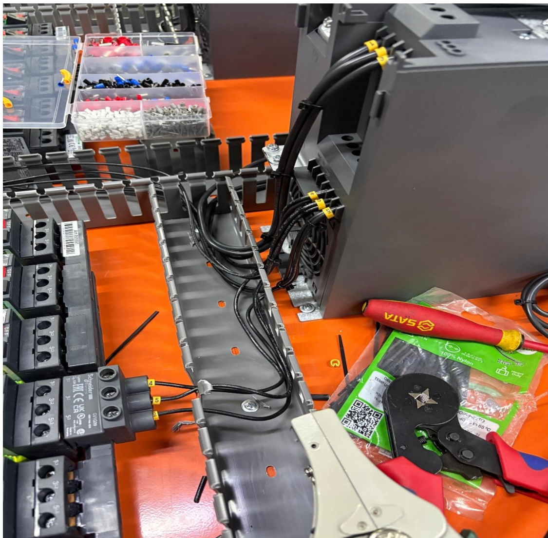
Figura 25 Instalación y cableado del variador de frecuencia en el tablero eléctrico.
