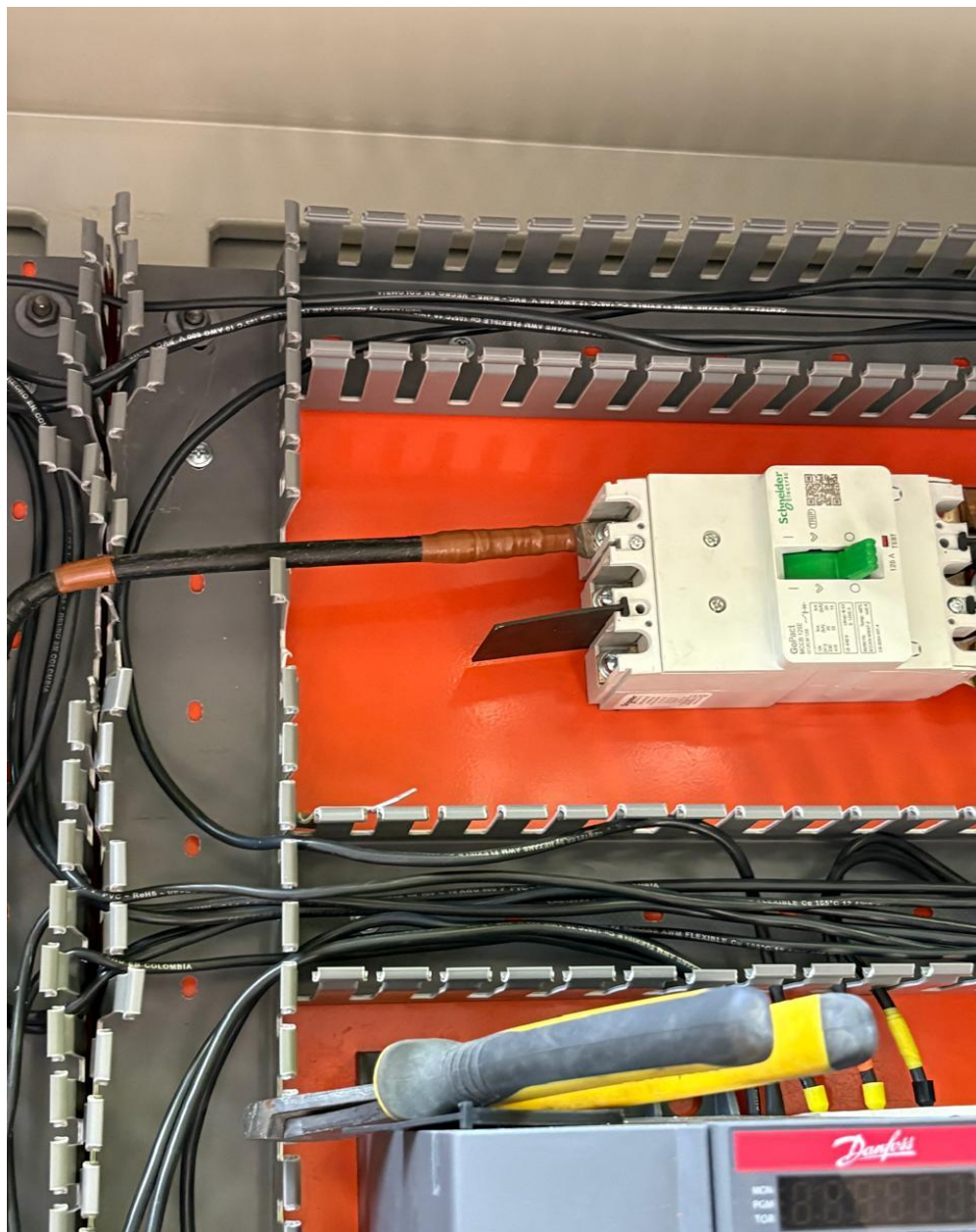
Figura 28 Conexión totalizador principal.
