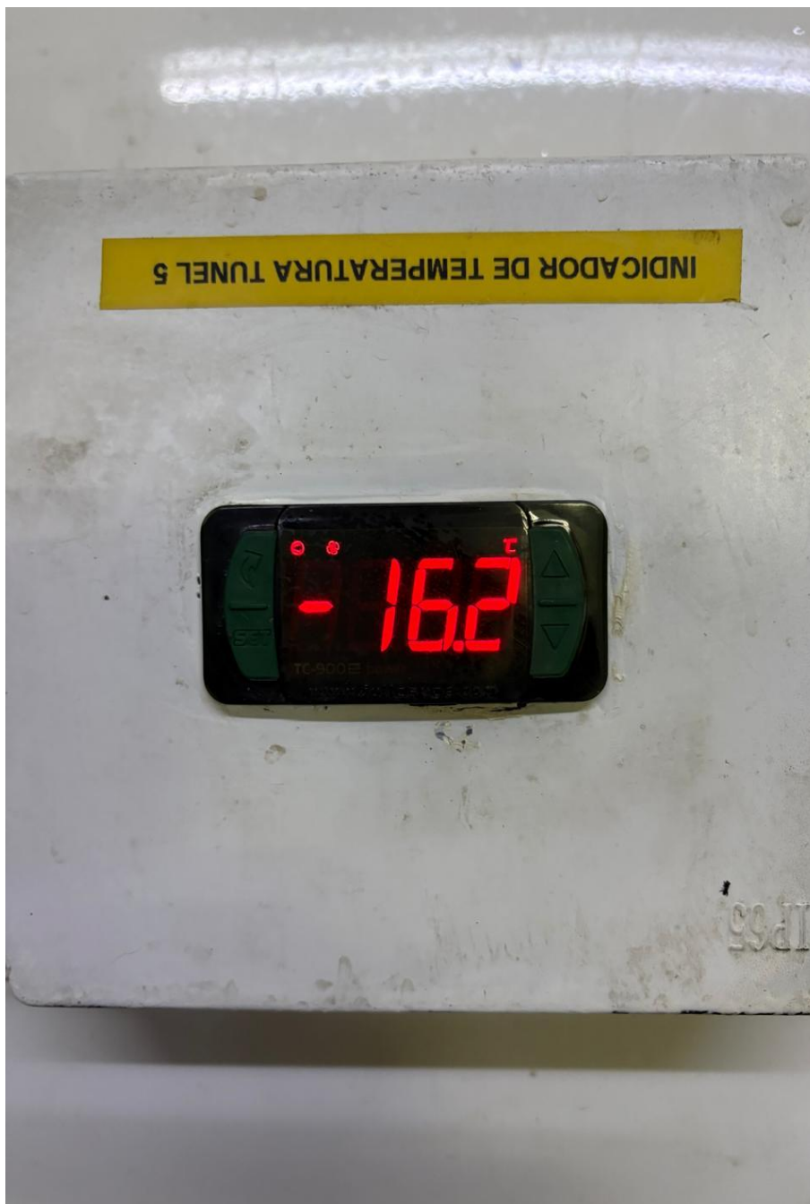
Figura 4 Indicador de temperatura de uno de los túneles
