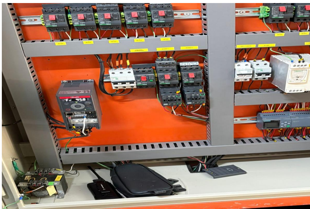
Figura 31 variador del sistema de bombeo.
