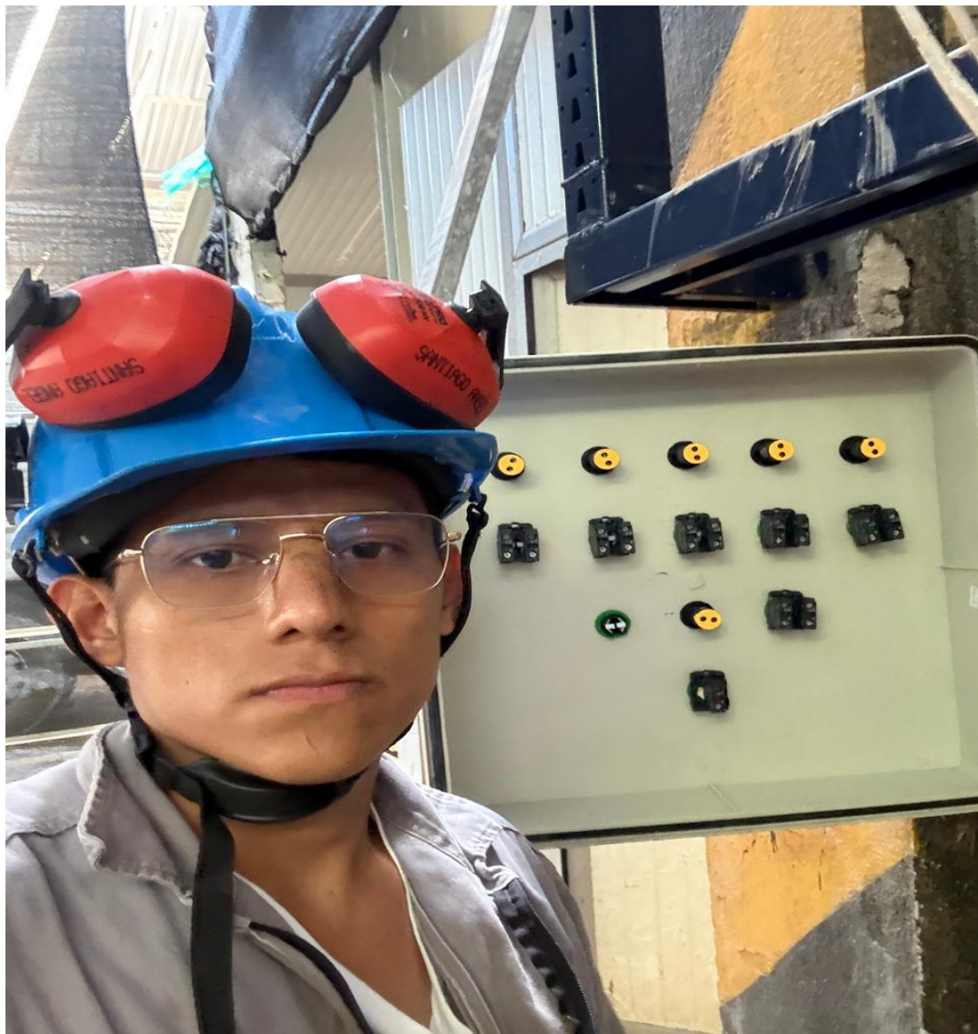
Figura 29 tablero de manual o automático.
