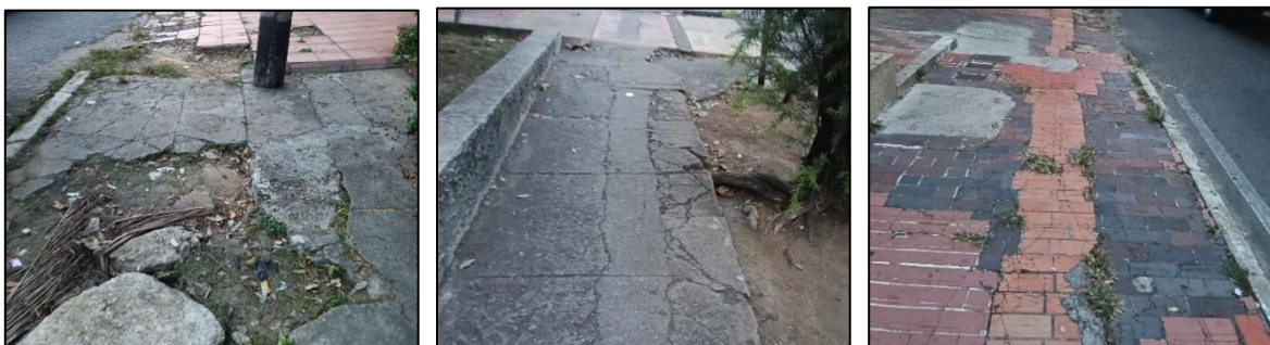
Figura 2. Estado actual de los andenes en la zona de estudio.
