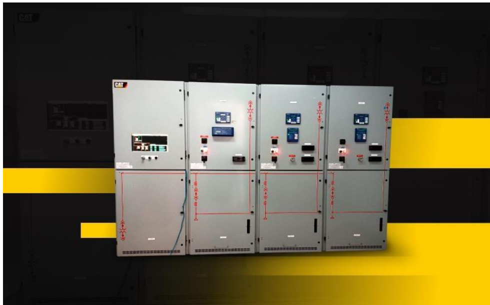
Imagen 15. ATS (Automatic Transfer Switch)
