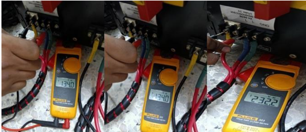
Imagen 98. Tensiones de línea y de fase, bornera de entrada. (Autores, 2025)
