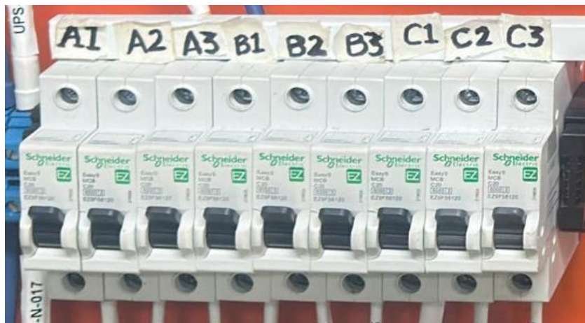
Imagen 109. Identificación de circuitos regulados. (Autores, 2025)
