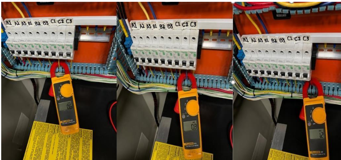
Imagen 113. Registro de corrientes en circuitos C1, C2 y C3. (Autores, 2025)
