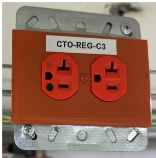
Imagen 110. Identificación tomacorriente regulada. (Autores, 2025)
