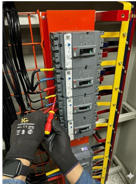
Imagen 93. Conexión alimentación desde tablero de motores. (Autores, 2025)
