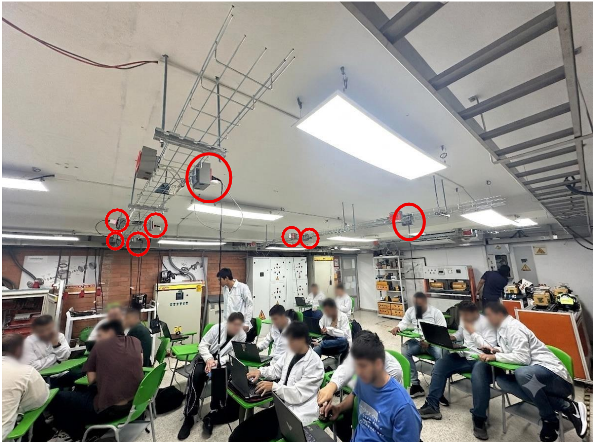
Imagen 101. Cargas conectadas a la red regulada de laboratorio de máquinas eléctricas II. (Autores, 2025)
