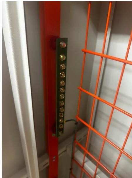
Imagen 63. Disponibilidad de puesta a tierra en el tablero TDG principal. (Autores, 2025)
