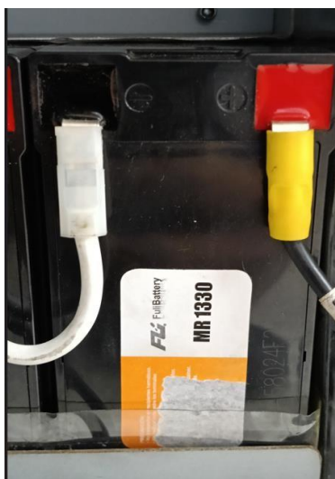
Imagen 56. Tipo de batería de la UPS. (Autores, 2025)
