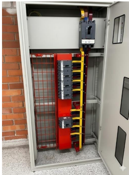
Imagen 60. Tablero de distribución general (tablero general motores). (Autores, 2025)
