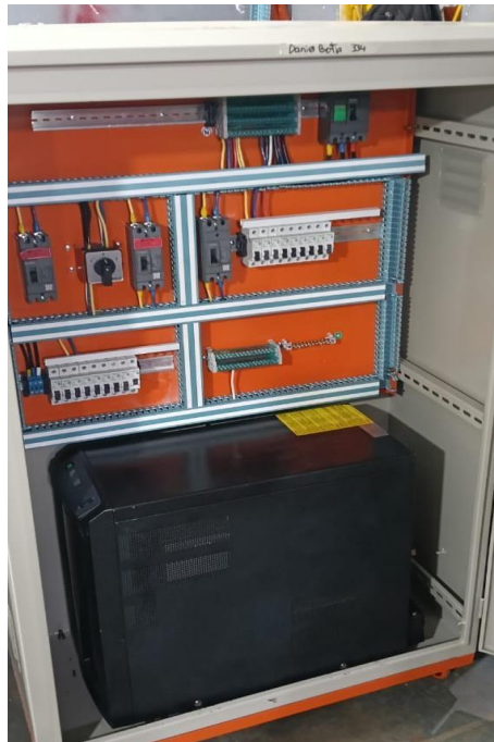
Imagen 94. Ubicación del UPS y su banco de baterías interno. (Autores, 2025)
