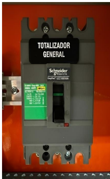
Imagen 81. Totalizador general del tablero UPS. (Autores, 2025)
