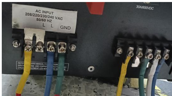
Imagen 95. Borneras de la UPS. (Autores, 2025)
