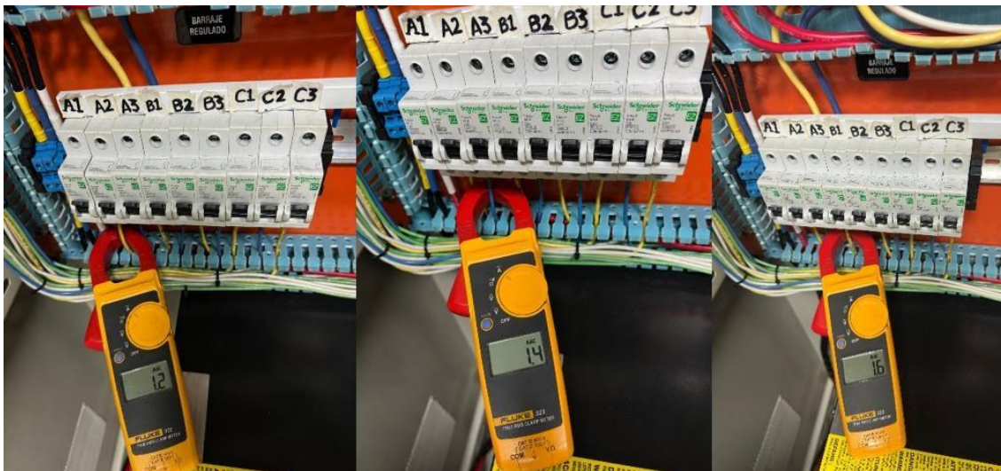
Imagen 111. Registro de corrientes en circuitos A1, A2 y A3 en modo batería. (Autores, 2025)
