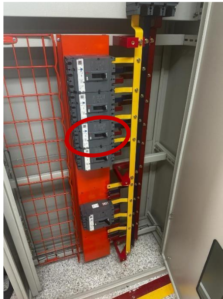
Imagen 61. Breaker de protección principal para el tablero UPS. (Autores, 2025)
