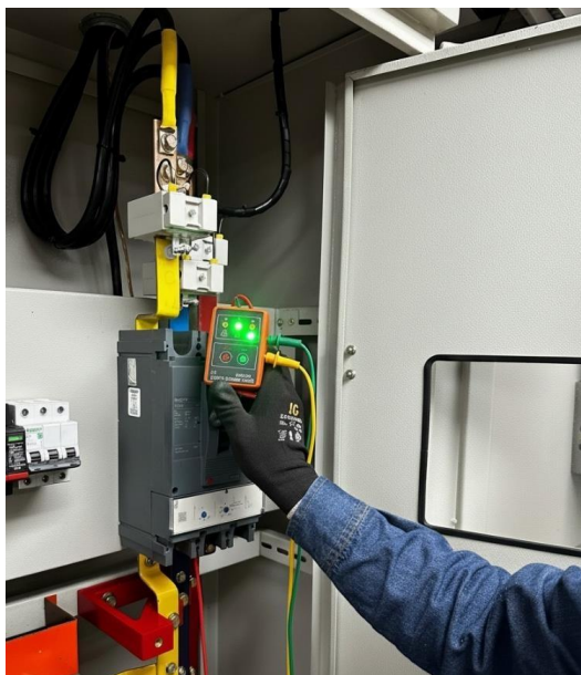
Imagen 91. Verificación de polaridad con secuenciómetro de fases en tablero de motores. (Autores, 2025)
