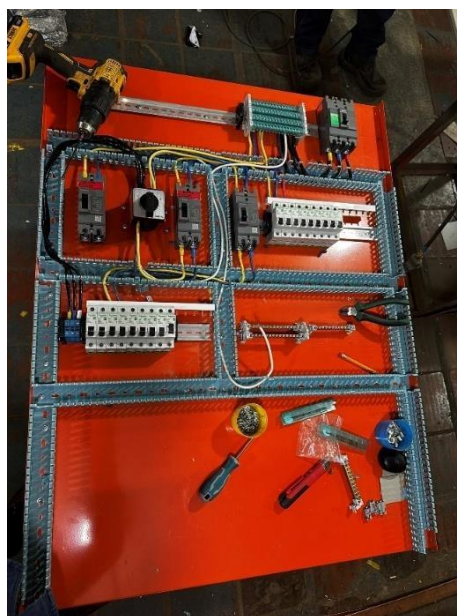
Imagen 89. Presentación de elementos y conexión de dispositivos eléctricos. (Autores, 2025)
