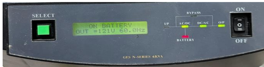
Imagen 108. Tensión y frecuencia de salida. (Autores, 2025)
