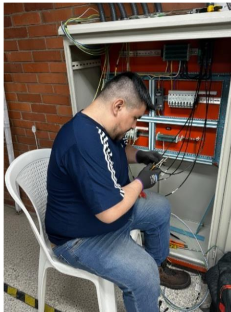
Imagen 92. Conexión acometida de alimentación a tablero UPS. (Autores, 2025)
