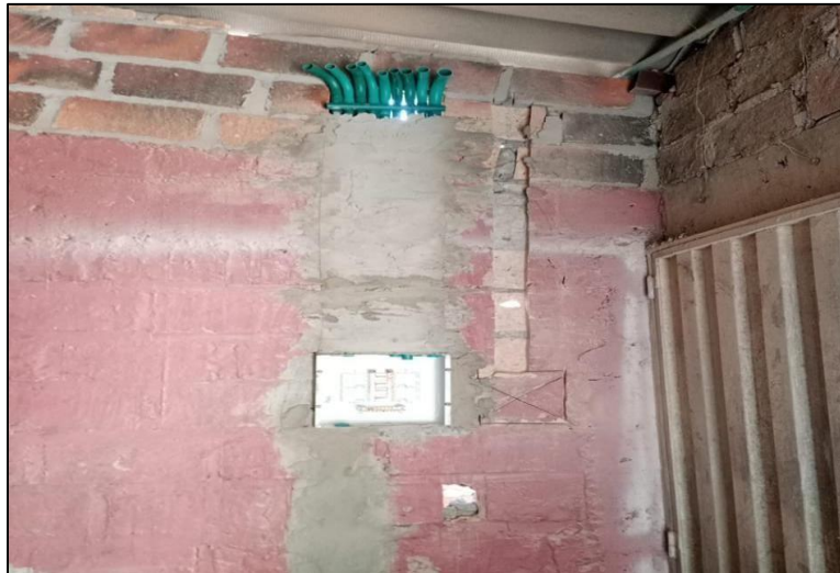
Figura 24. Tubería conduit PVC empotrada en pared
