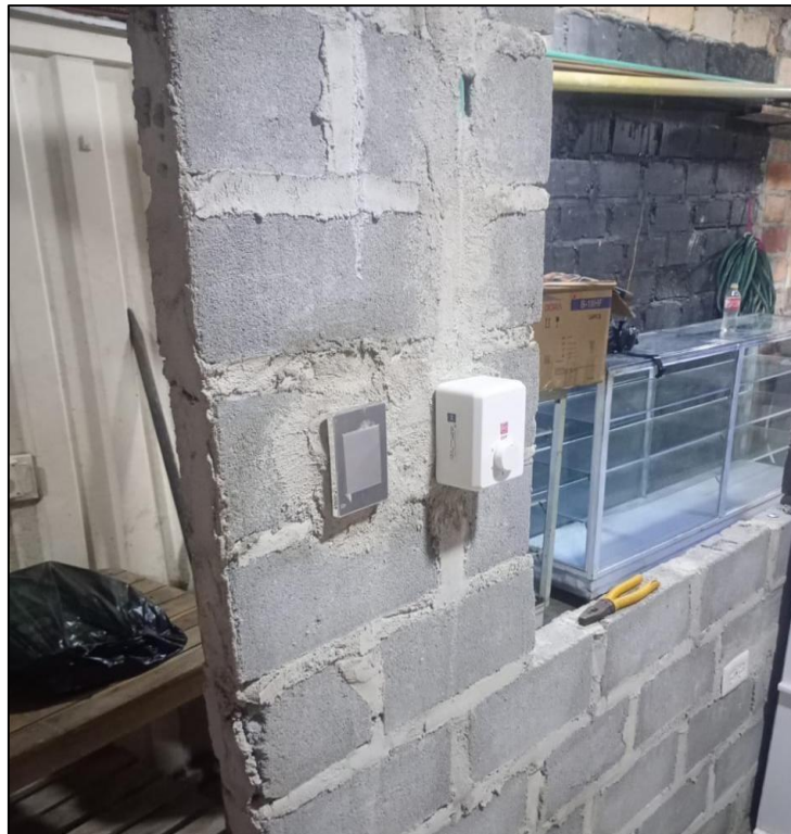
Figura 36. Tomacorriente e interruptor instalados
