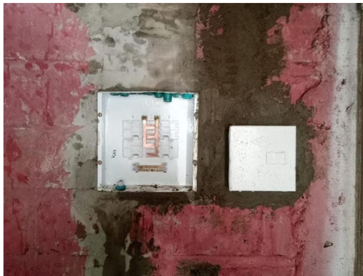
Figura 21. Tablero de distribución empotrado en pared
