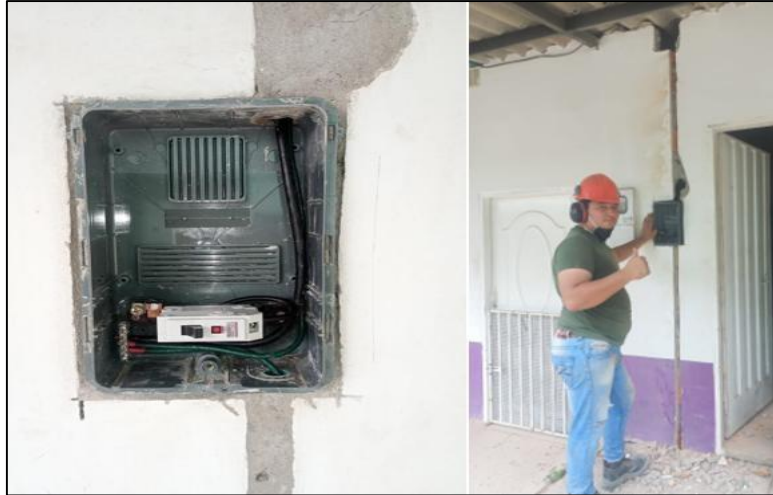
Figura 18. Caja del totalizador con interruptor principal
