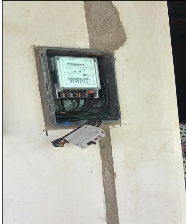
Figura 17. Medidor monofásico instalado en fachada
