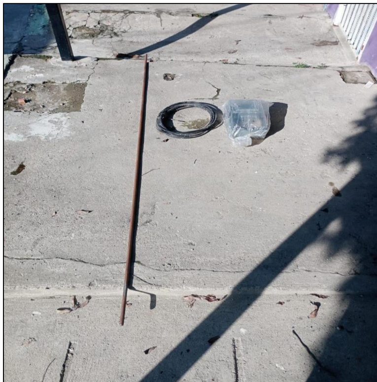
Figura 14. Materiales del sistema de puesta a tierra
