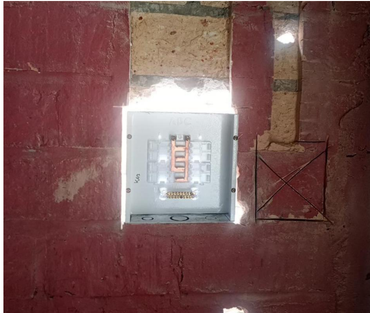
Figura 22. Tablero principal montado y conectado
