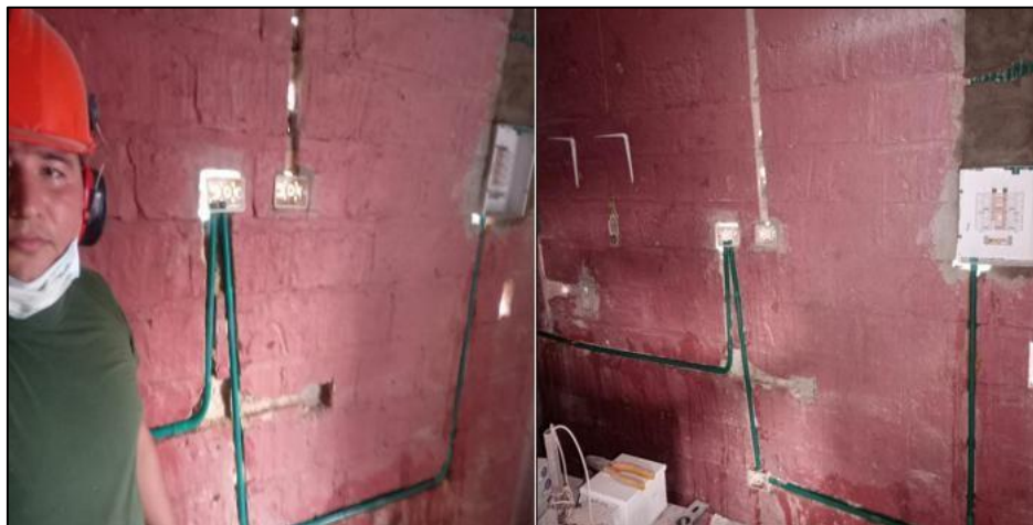
Figura 25. Llegada de tuberías al tablero principal
