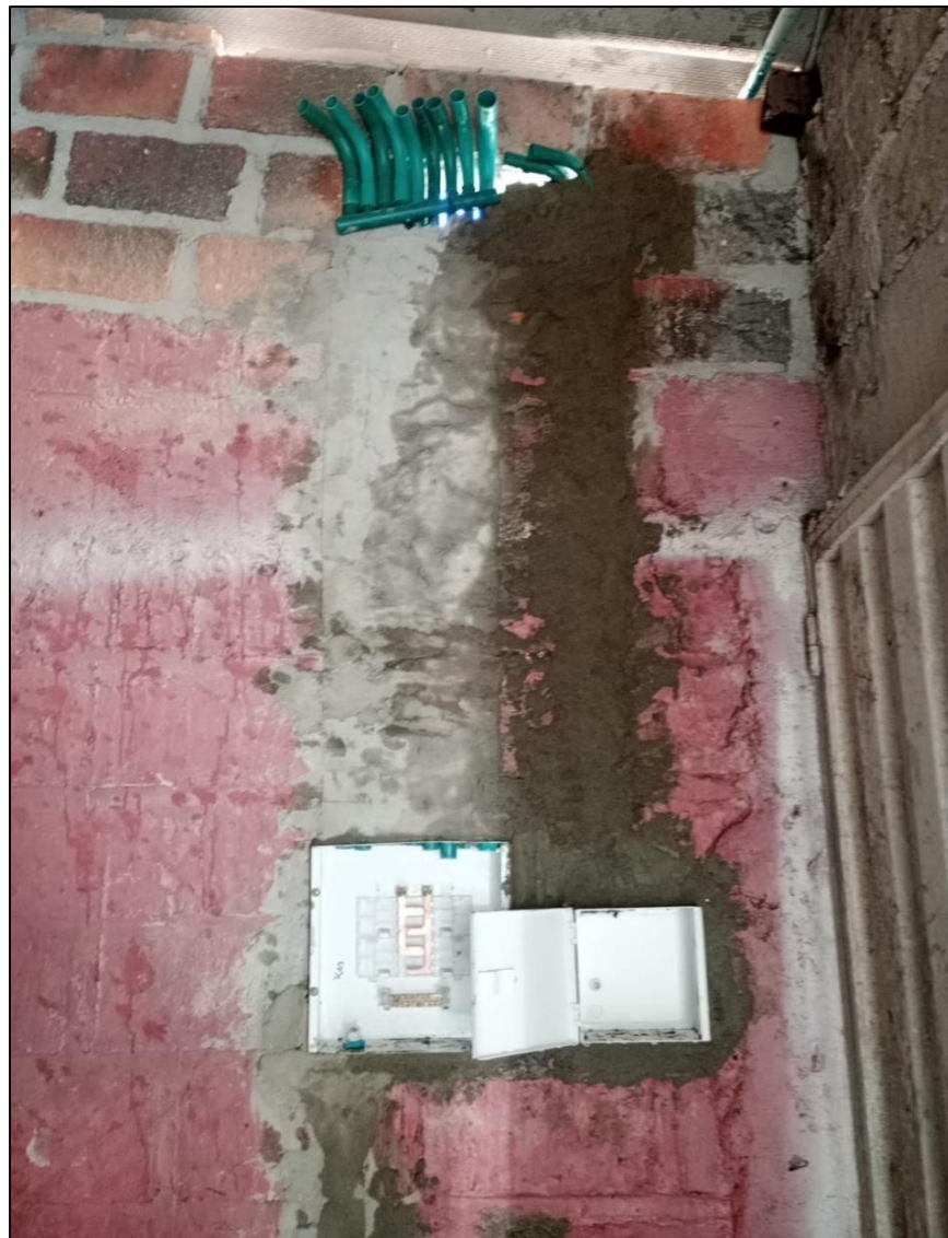
Figura 29. Caja de paso y derivación de conductores
