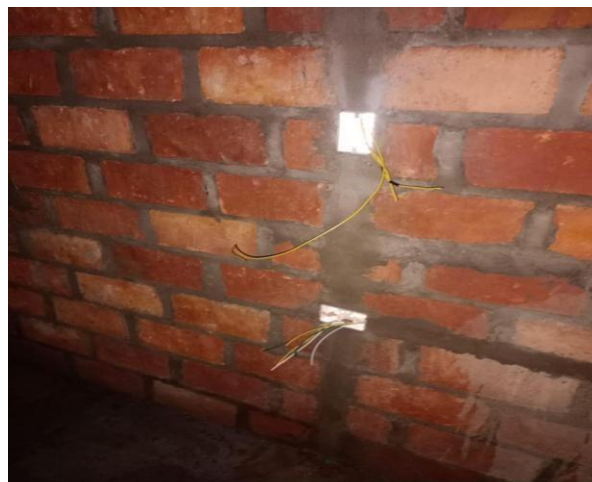
Figura 35. Salidas para tomacorriente preparadas
