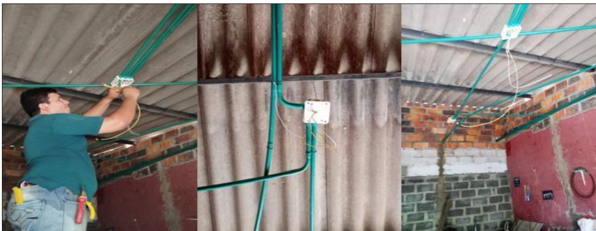
Figura 27. Tubería aérea de alimentador 3/4"
