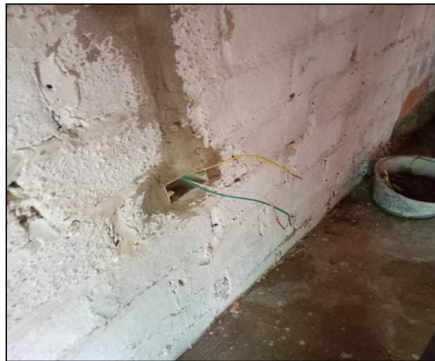
Figura 34. Cables de fase, neutro y tierra en punto de salida
