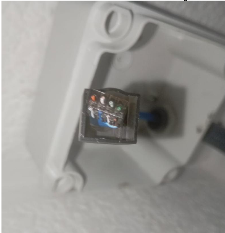
Ilustración 14. Mantenimiento cámara de seguridad.
