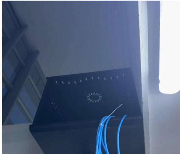
Ilustración 17. Instalación gabinete para puntos de red
