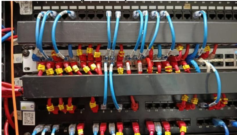
Ilustración 7. Organización y distribución de cableado
