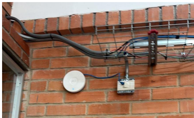
Ilustración 10. Instalación Access Point
