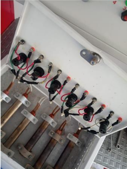
Figura 1 Mantenimiento a banco de resistencias Fuente: autor
