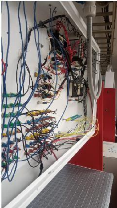
Figura 6 Organización de cableado en bancos de trabajo Fuente: autor
