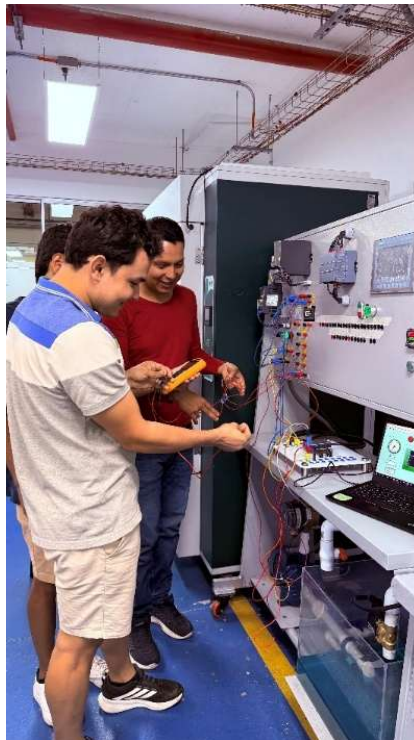
Figura 19. Validación de funcionamiento CR18-8DP
