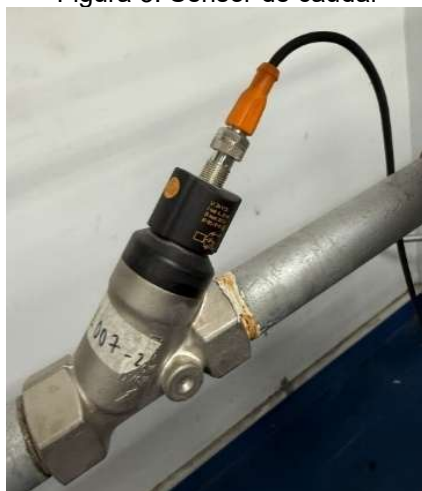
Figura 3. Sensor de caudal
