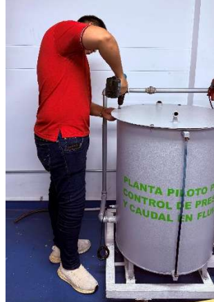
Figura 9. Instalación de sensores
