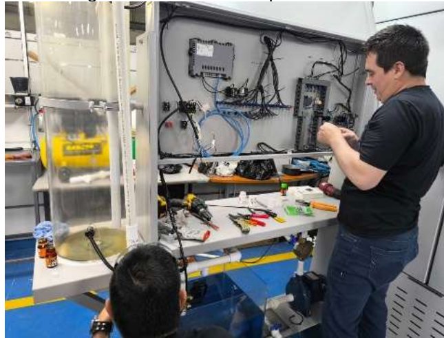
Figura 24. Cableado de parte eléctrica
