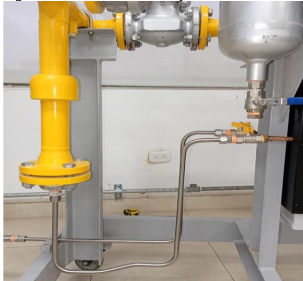
Figura 34. Tubería de entrada y salida del calentador
