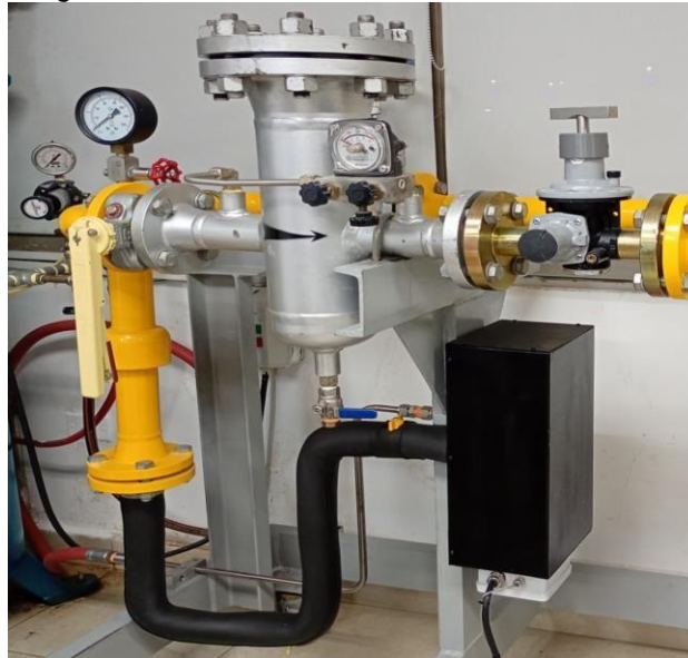
Figura 35. Calentador con aislamiento e instalado
