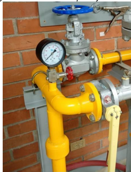
Figura 11. Válvulas mariposa y manómetros
