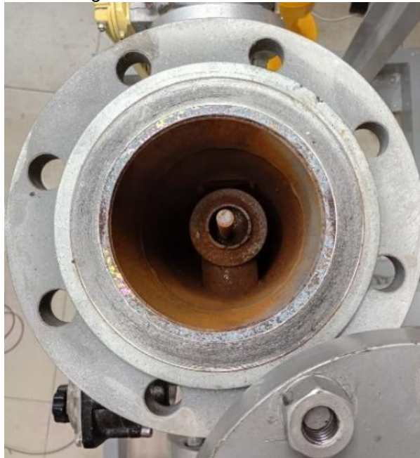
Figura 25. Corrosión en el sistema
