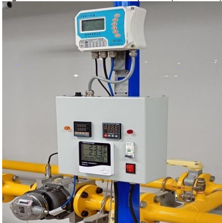
Figura 38. Tablero de control de temperatura (vista externa)
