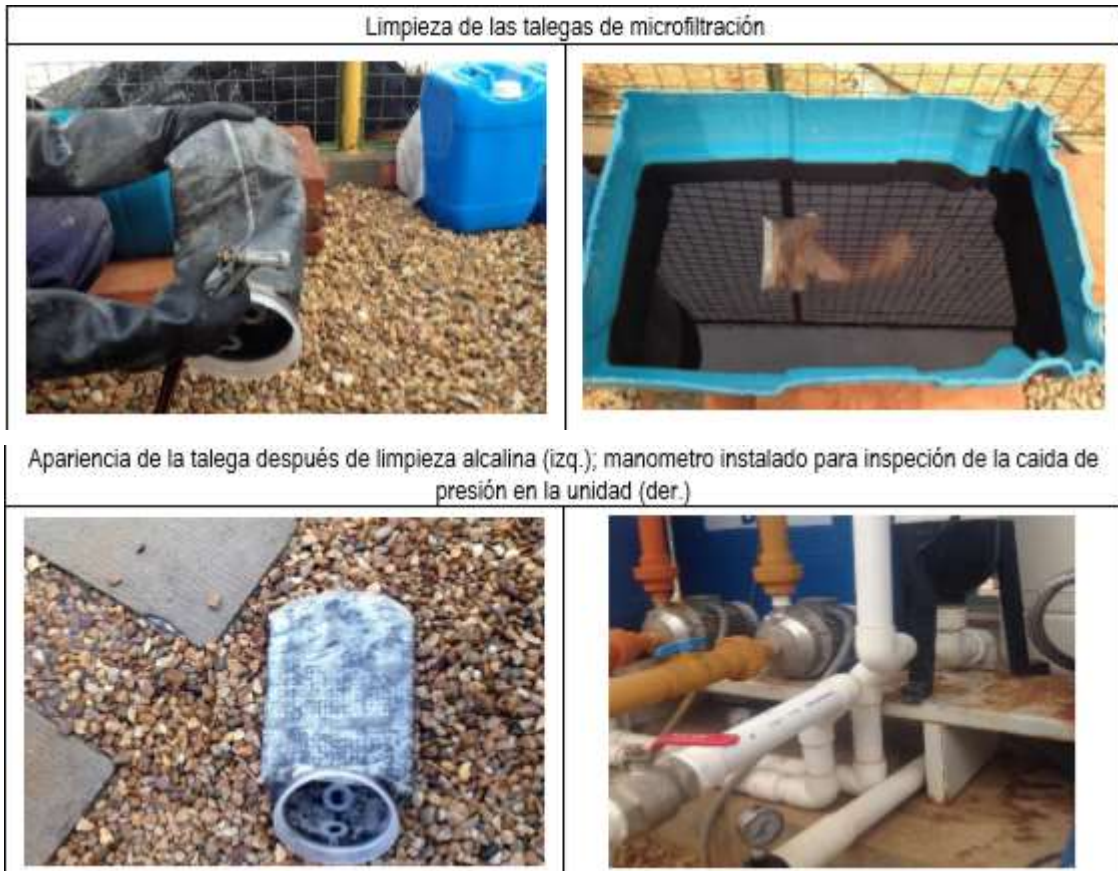
Imagen 32: Mantenimiento realizado a la unidad de microfiltración
