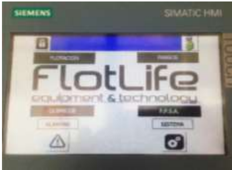
Imagen 25: Panel de control del DAF
