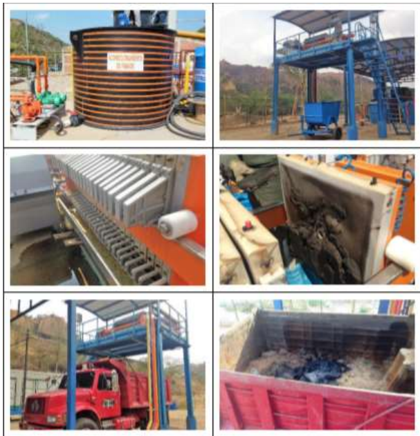
Imagen 38: Tanque Acondicionador de Lodos y Filtro Prensa
