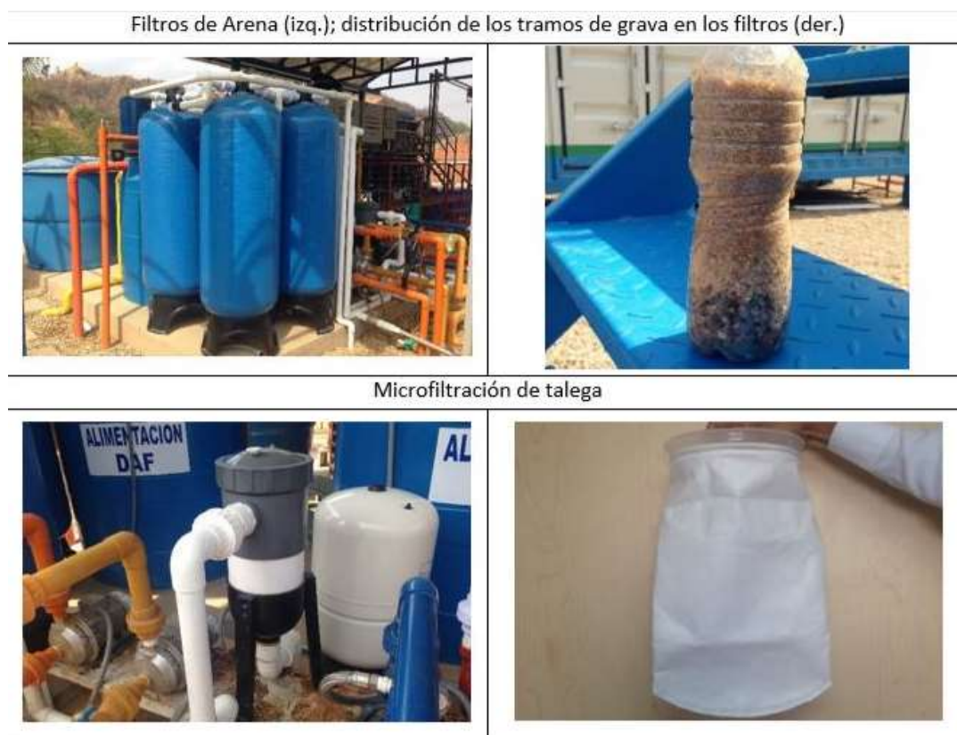
Imagen 30: Filtros de arena y microfiltración de talega
