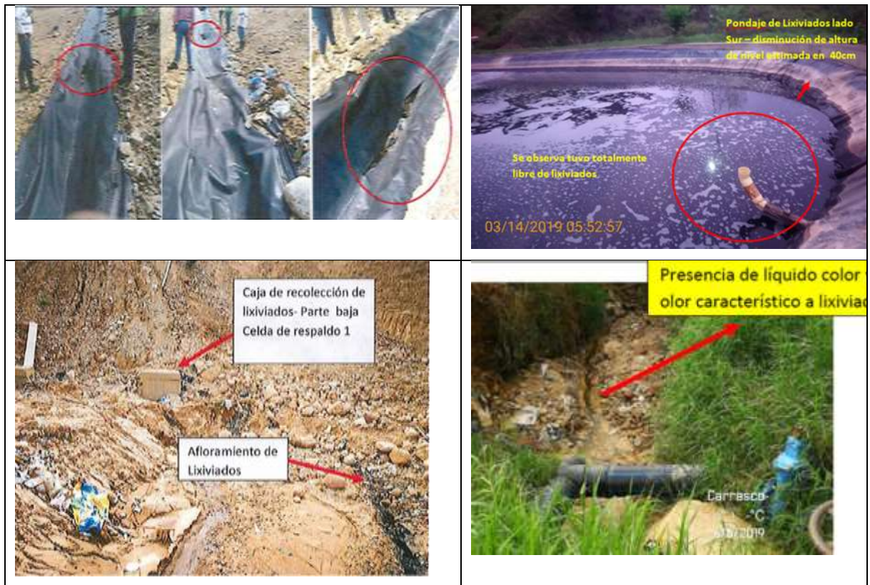
Imagen 14: Incidentes con lixiviados, canaletas y aguas lluvias
