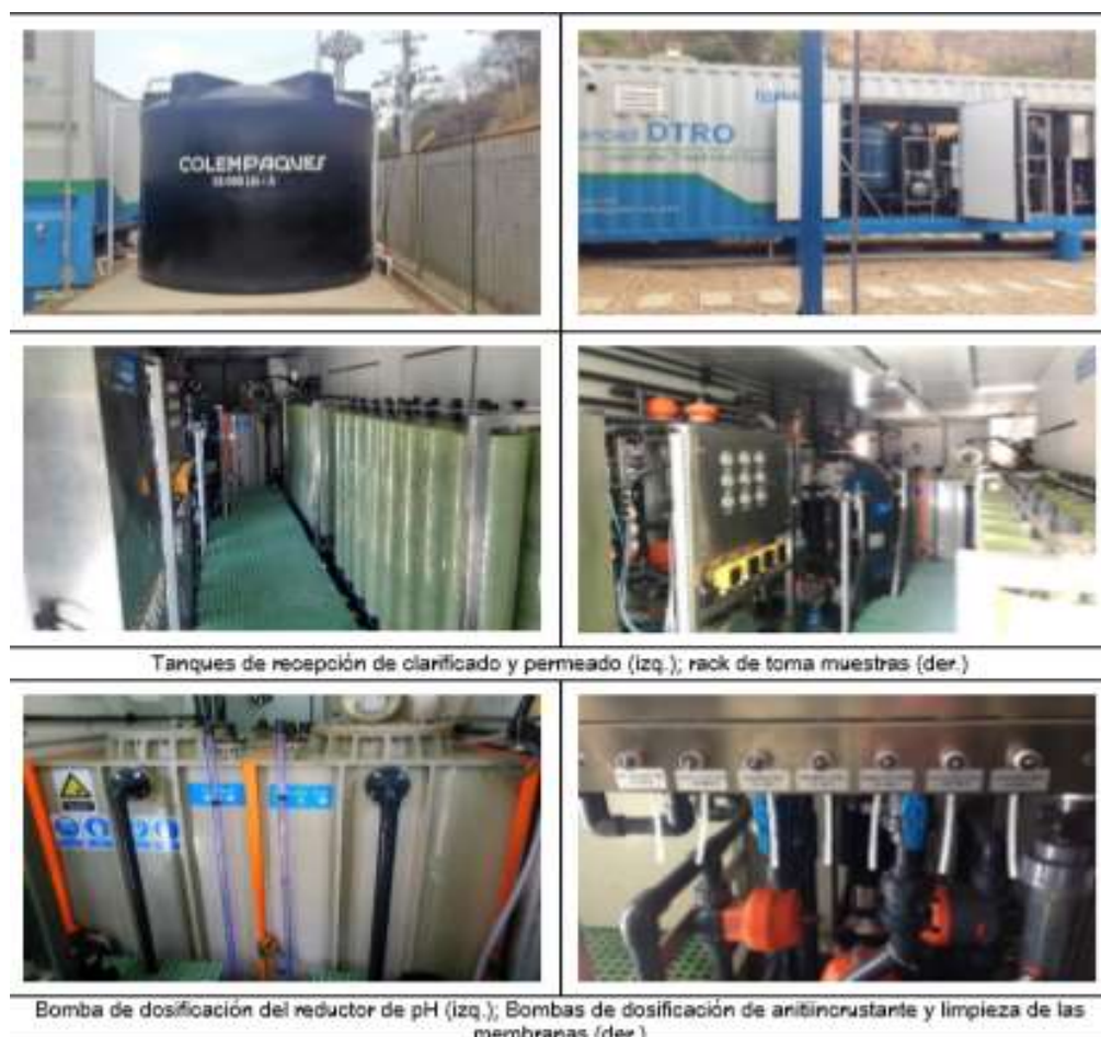
Imagen 33: Sistema de Filtración por Membranas (DTRO)
