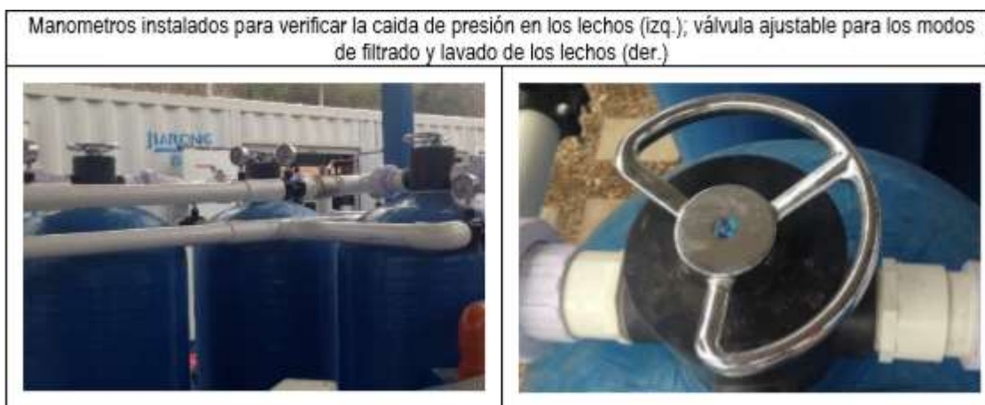
Imagen 31: Filtros de Arena y grava
