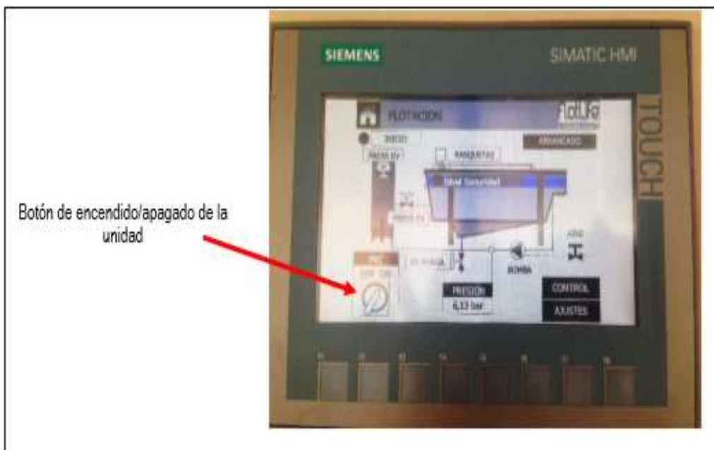
Imagen 26: Panel de control del DAF: Opción “Flotación”
