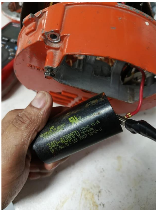
Imagen 1. Diagnostico eléctrico de la electrobomba del módulo de Perdidas en tuberías.
