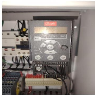
Figura 2. Variador de frecuencia.
