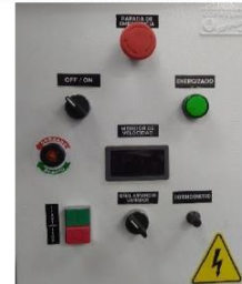
Figura 4. Tablero de control.
