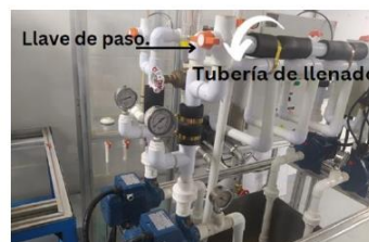
Figura 4. Tubería de Cebado.
