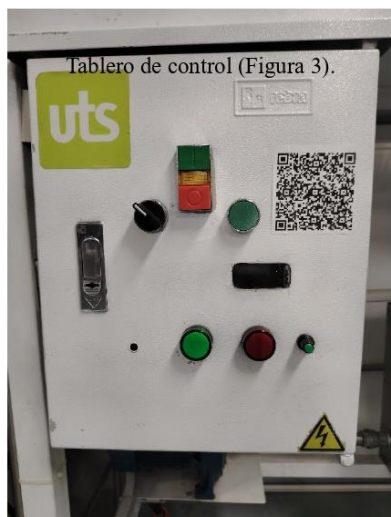
Figura 4. Tablero de control.
