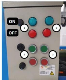
Figura 3. Tablero de control.
