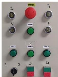
Figura 3. Tablero de control.
