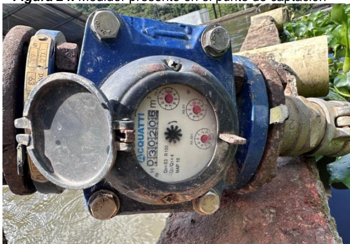
Figura 24. Medidor presente en el punto de captación
