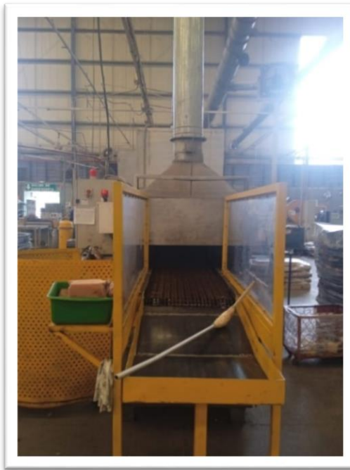
Figura 6. Horno para curado de elementos de línea 1
