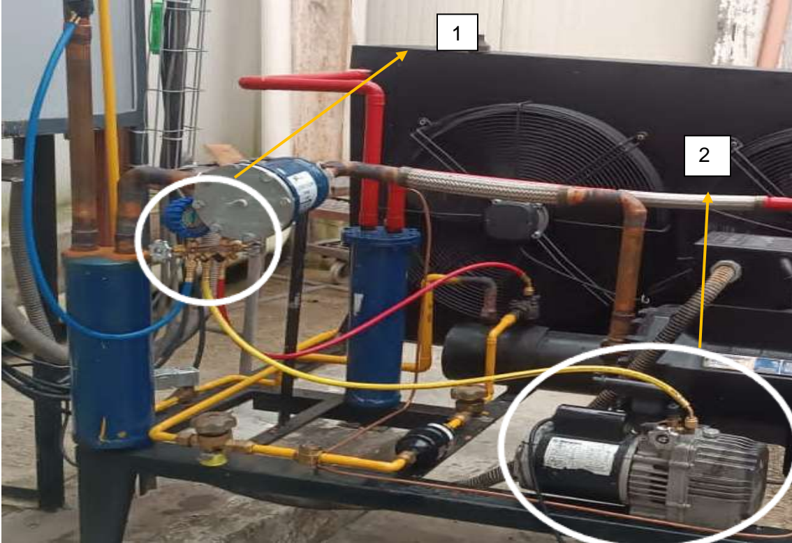
Figura 13. Conexión del Proceso de vacío del sistema
