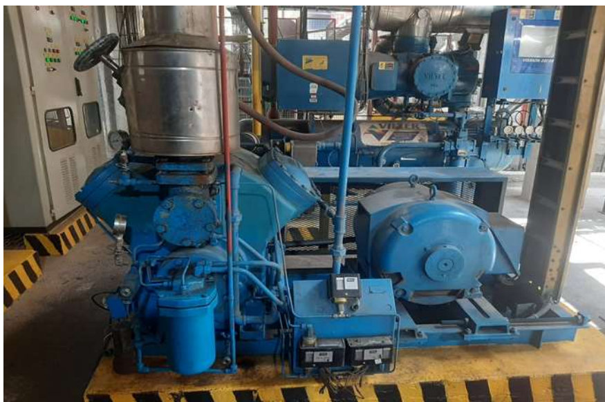
Figura 7. Compresor del cuarto 609
