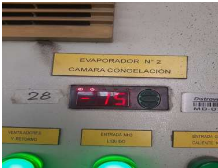
Figura 5. Controlador digital 1 del túnel Madef
