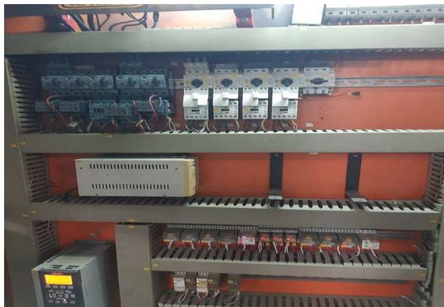
Figura 10. Tablero de control del IQF
