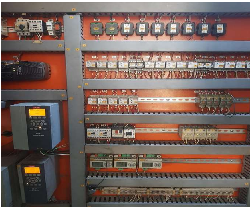
Figura 17. Tablero de control del túnel Madef
