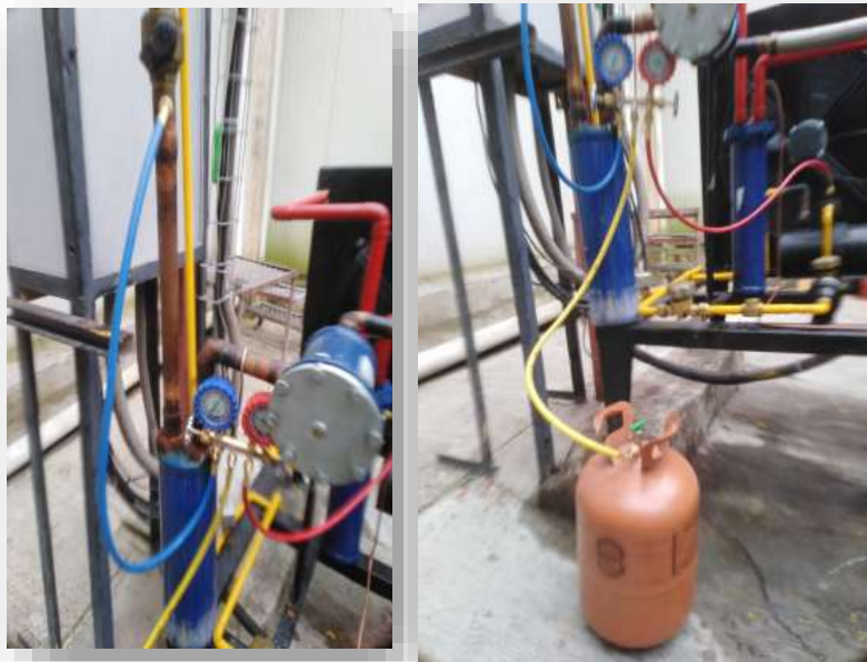
Figura 15. Inyección de refrigerante
