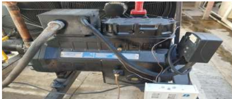
Figura 3. Compresor Copeland de 7,5 hp
