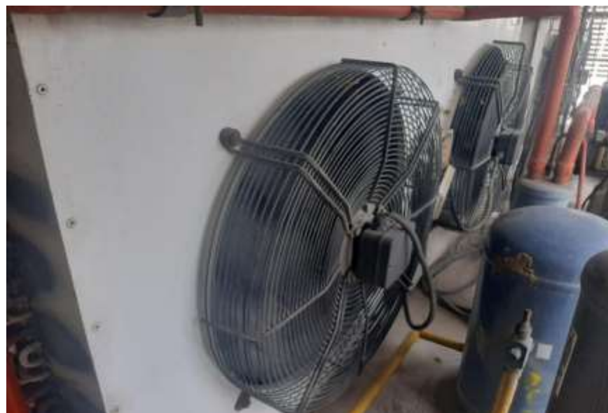
Figura 2. Condensadora del equipo Empaque 1
