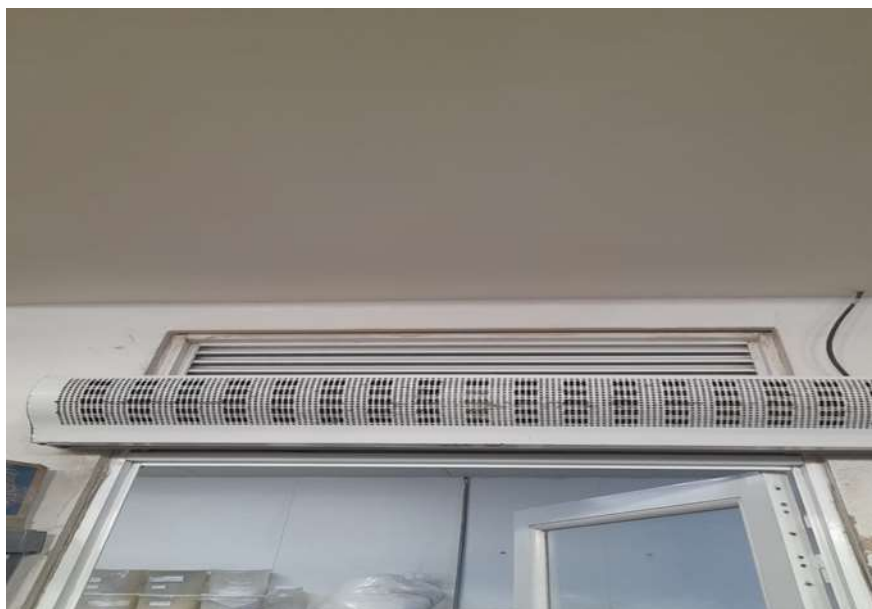
Figura 21. Cortina de aire del área de almacén
