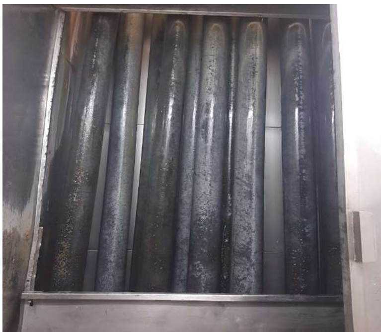
Figura 14. Evaporador de la Planta hielo
