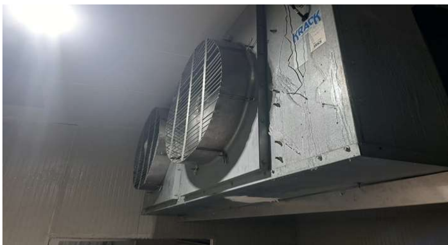
Figura 32. Motores túneles Vilter
