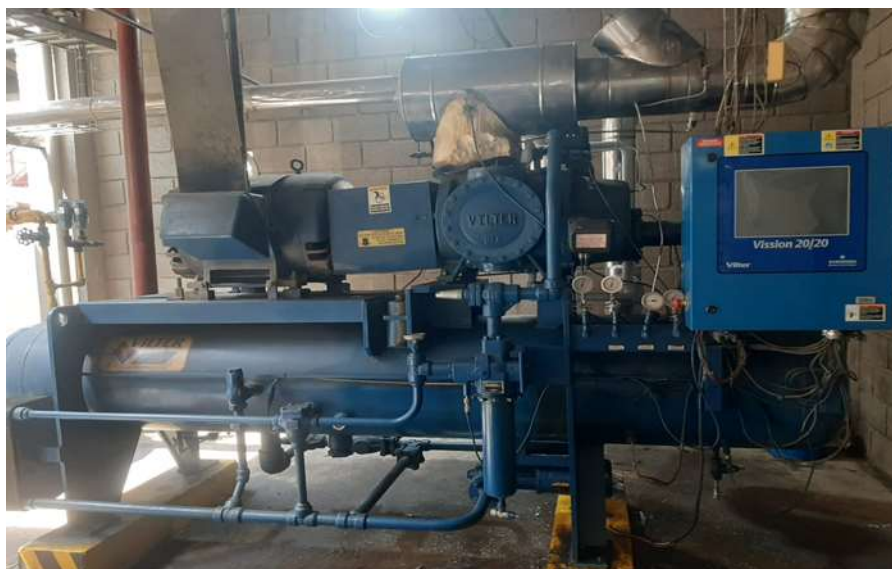
Figura 15. Compresor del túnel continuo Vilter
