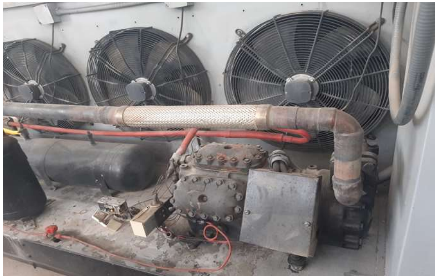
Figura 34. Compresor Choque Térmico 3
