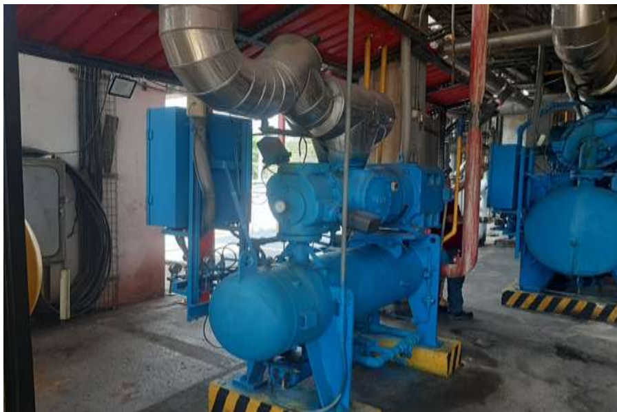
Figura 25. Arranque de compresores del IQF
