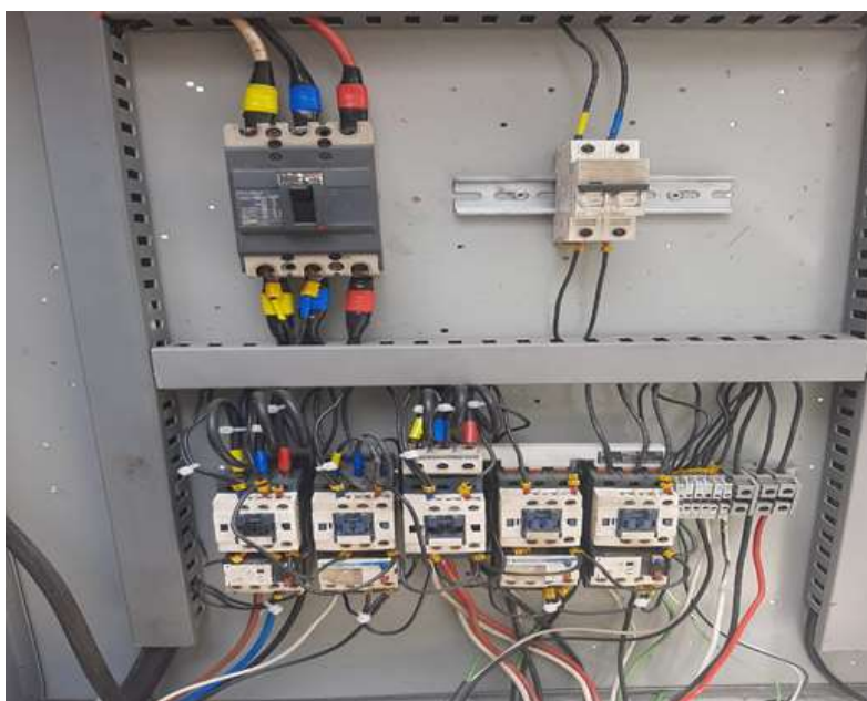
Figura 3. Tablero de control de la Rampa de Despacho logística 1 y 2
