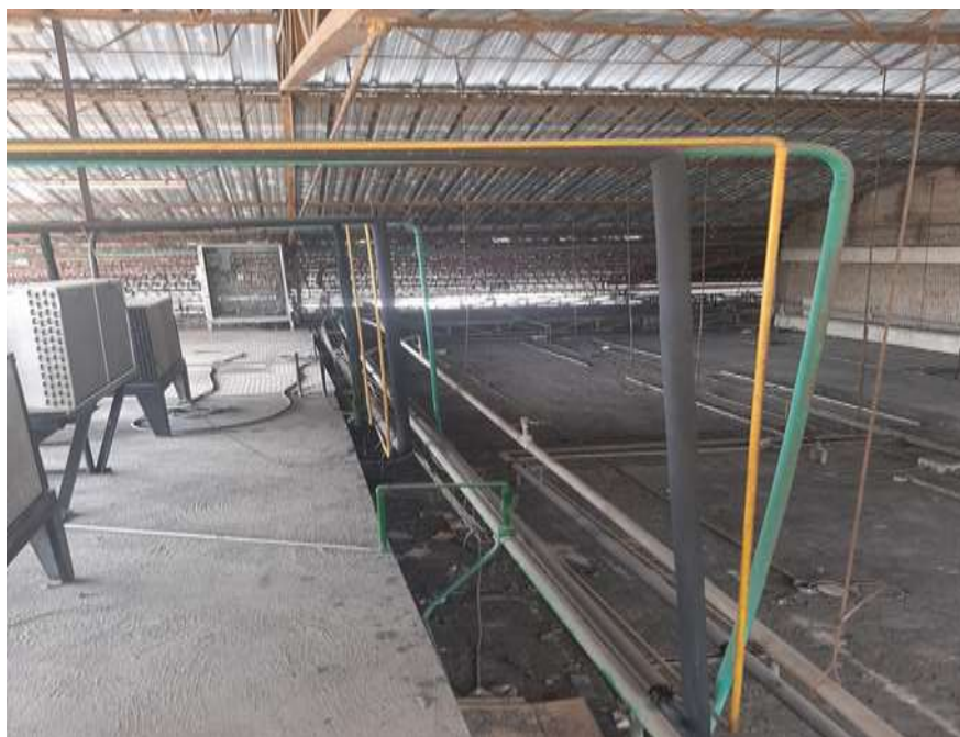
Figura 9. Tubería del área de Delecta
