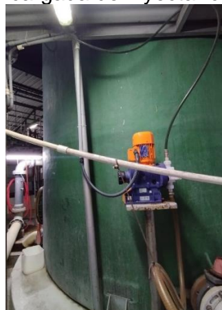
Figura 9 . Bomba encargada de inyectar clarex al agua residual
