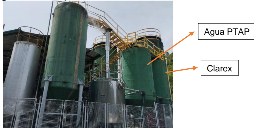
Figura 35 . Tanques almacenamiento PTAR
