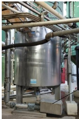
Figura 23 . Tanque de calentamiento
