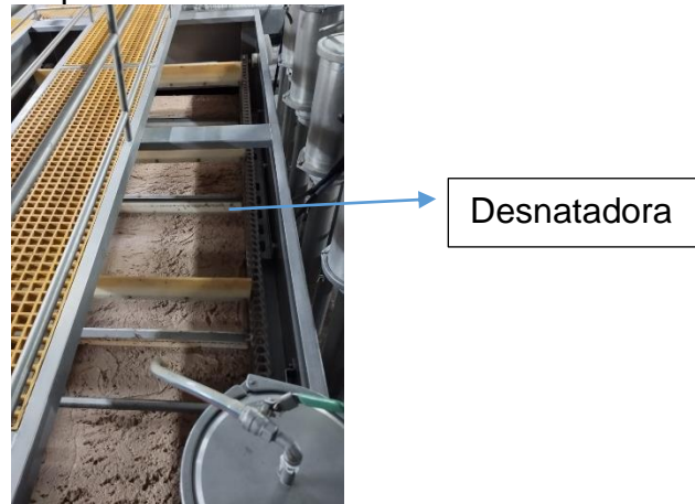
Figura 20 . Capa de lodos celda de flotación
