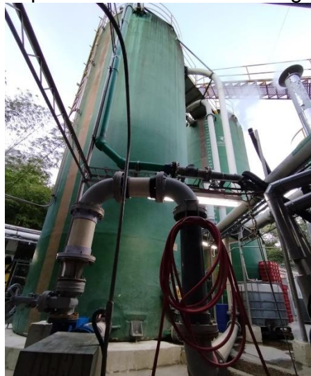
Figura 6 . Tanques de almacenamiento agua residual
