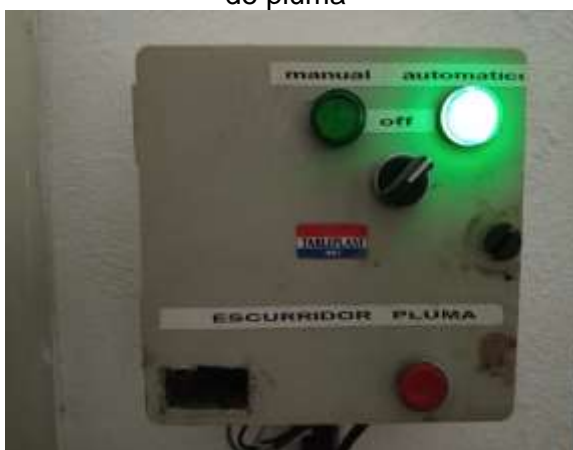
Ilustración 11 tablero nuevo del escurridor de pluma
