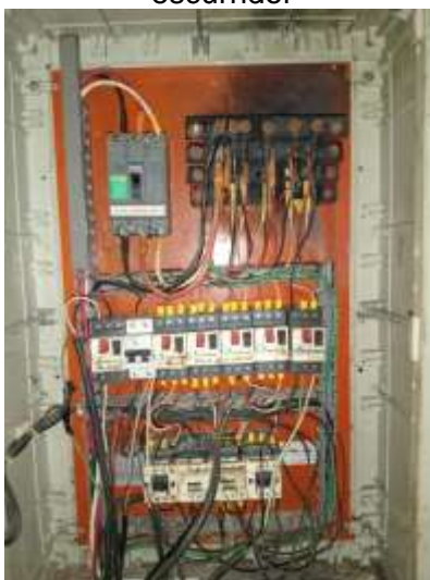
Ilustración 7. Tablero donde se encuentra el encendido del escurridor
