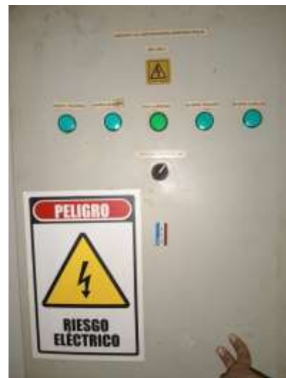
Ilustración 8. Tablero de control
