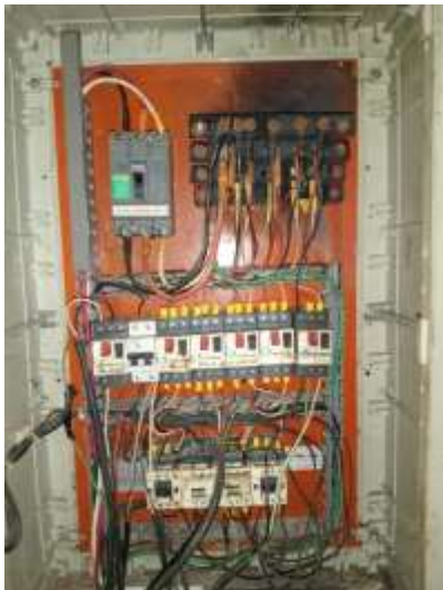
Ilustración 2. Tablero de control y distribución
