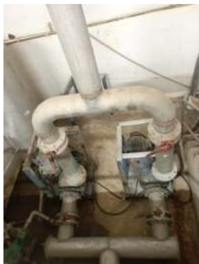
Ilustración 6. Bombas de transporte de pluma
