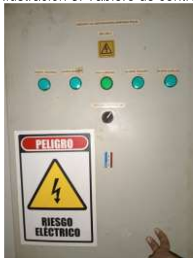
Ilustración 3. Tablero de control
