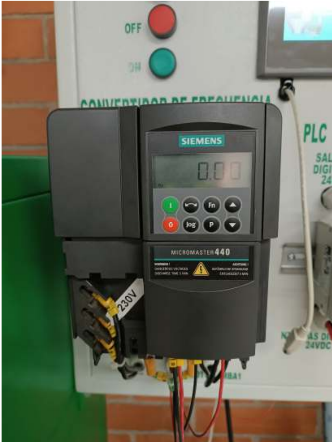
Figura 19 Variador de frecuencia
