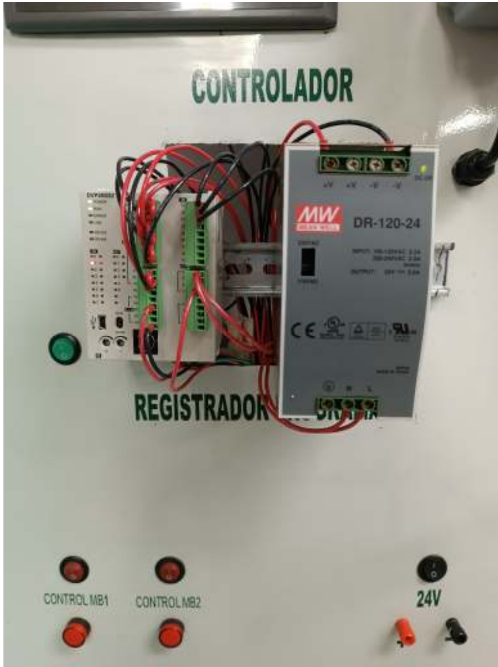
Figura 23 PLC DVP20SX2 + fuente de voltaje de 24 vdc.
