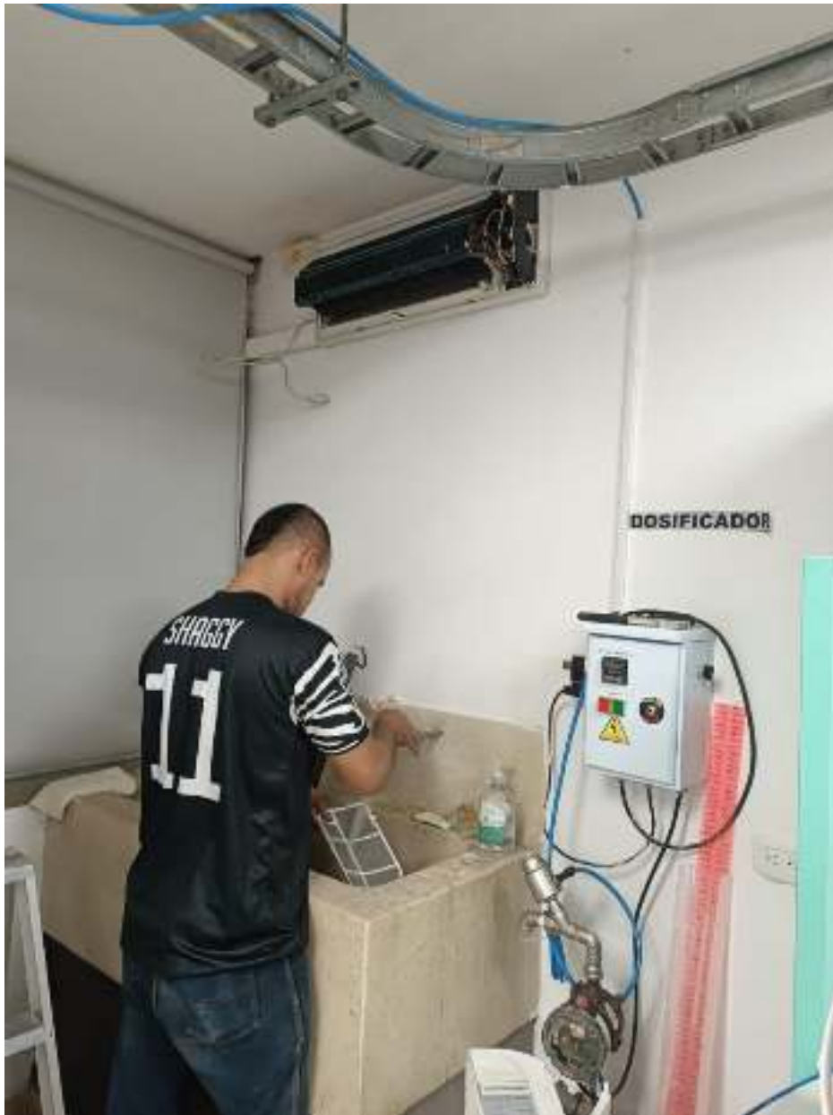
Figura 36 Mantenimiento autónomo de los aires acondicionados del laboratorio.
