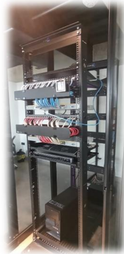
Figura 3 Servidor físico E&P Ingeniería
