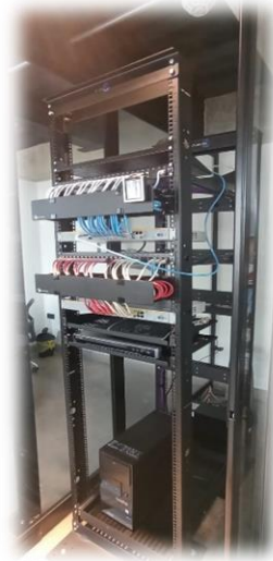
Figura 3 Servidor físico E&P Ingeniería
