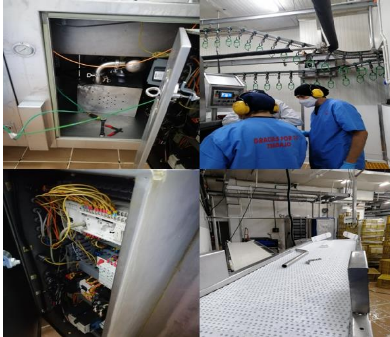
Figura 6. Inspección de mantenimiento y mantenimiento de equipos 2 de la planta.
