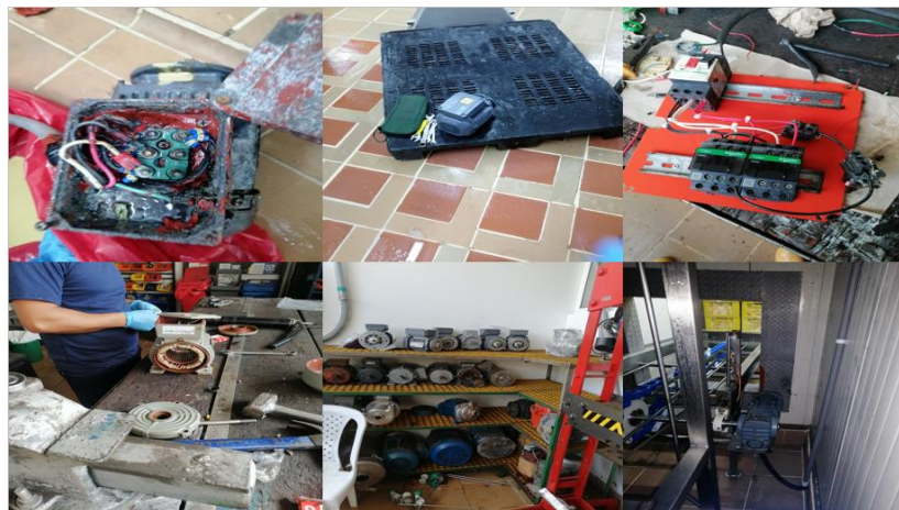
Figura 7. Inspección de mantenimiento y mantenimiento de equipos 2 de la planta.
