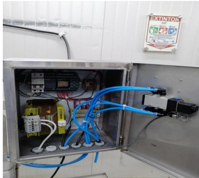
Figura 12. Tablero de control selladora.
