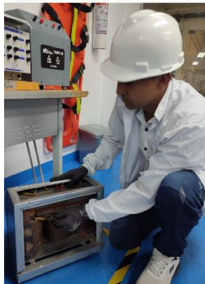
Figura 10 Mantenimiento preventivo de transformadores.
