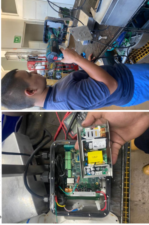
Figura 14 Revisión de sistema eléctrico por humedad.
