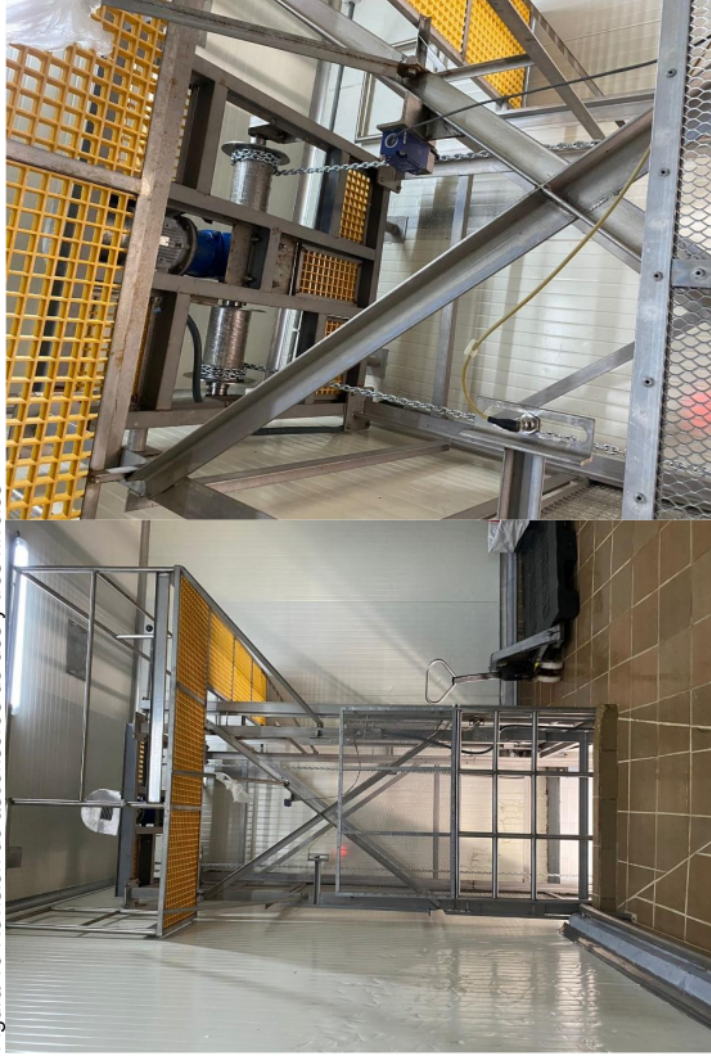
Figura 10 Revisión de ascensores de dos y tres niveles
