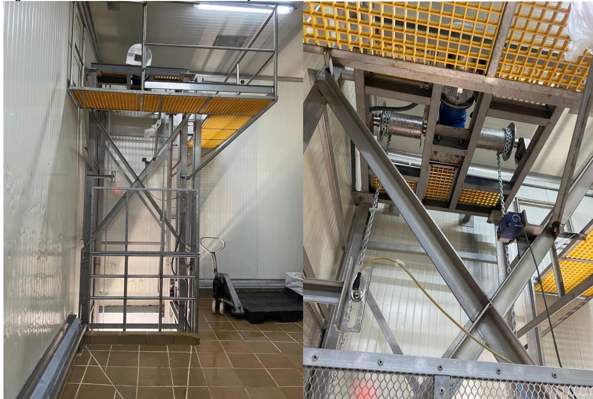
Figura 10 Revisión de ascensores de dos y tres niveles
