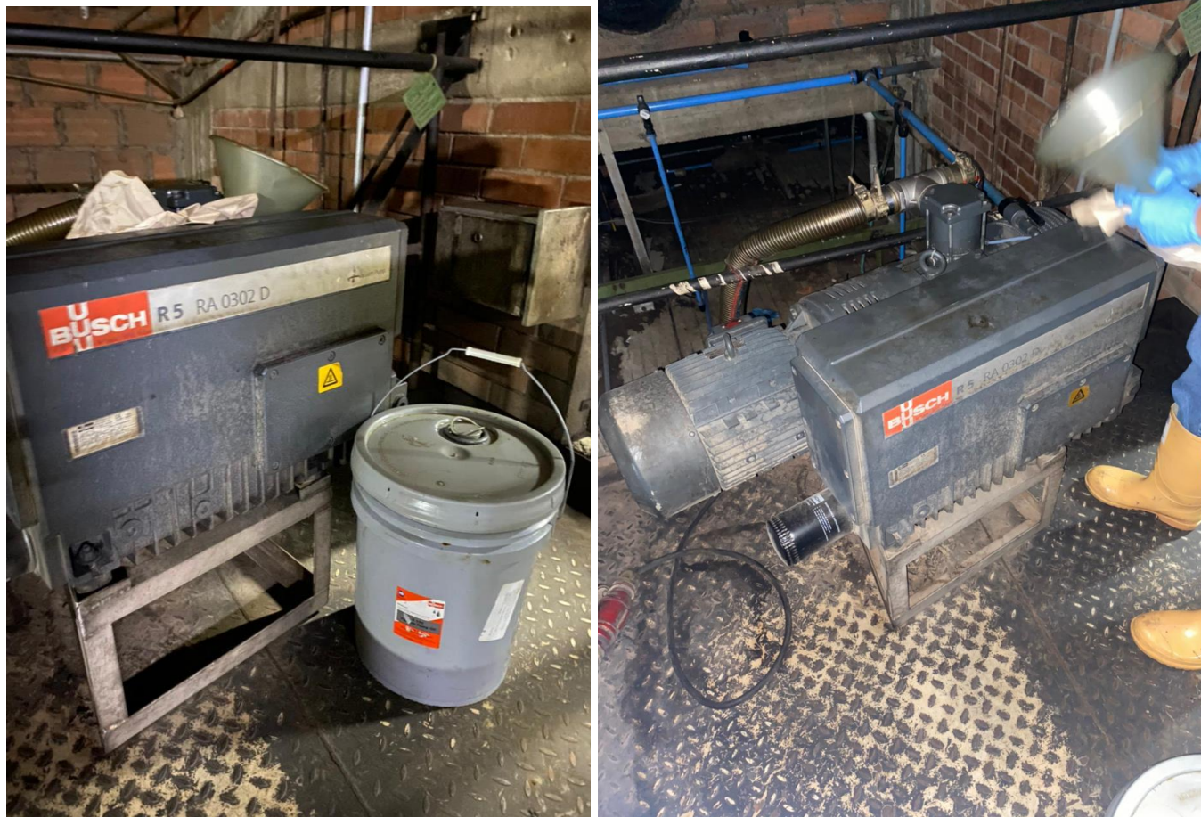
Figura 16 Mantenimiento preventivo a bomba de vacío busch R5
