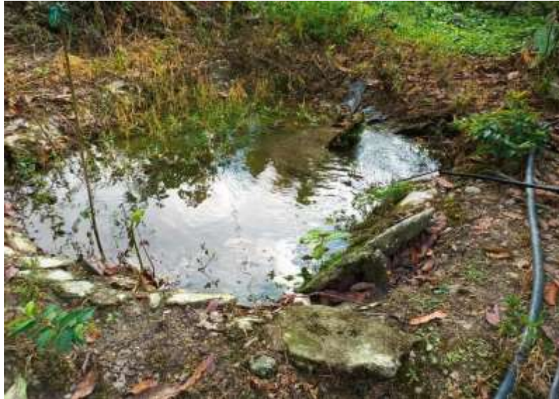
Figura 32. Pozo séptico en mal estado de la granja la Vega
