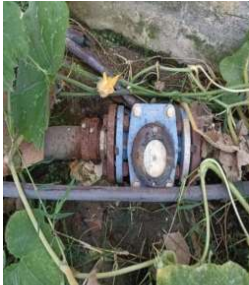
Figura 10. Sistema de macro medición instalado en la granja Amparo
