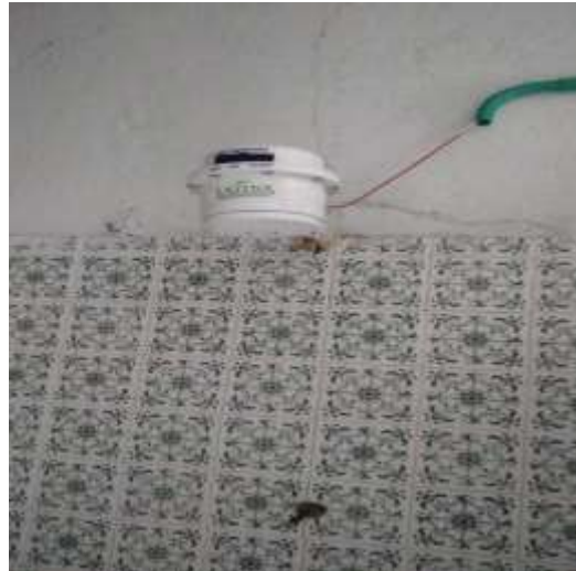
Figura 6. Instalación de ducha eléctrica de la granja Diamante I
