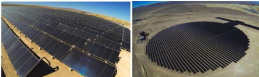
Figura 2. Planta termosolar mina de cobre Gabriela Mistral para electroobtención de energía térmica.
