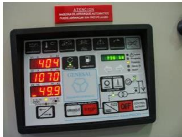
Figura 7. Cuadro de arranque automático
