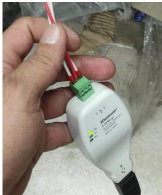
Figura 9. Puestos de conexión del RS-485
