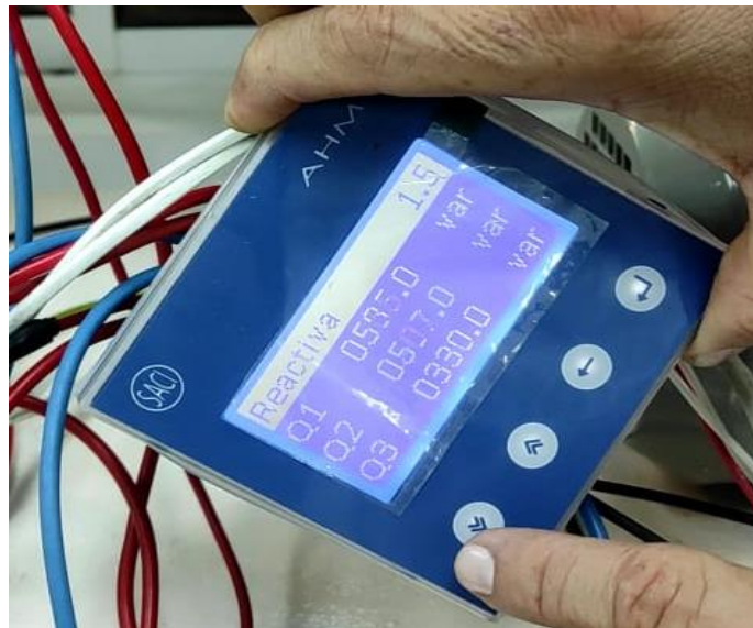
Figura 19. Potencia reactiva del Analizador AHM1
