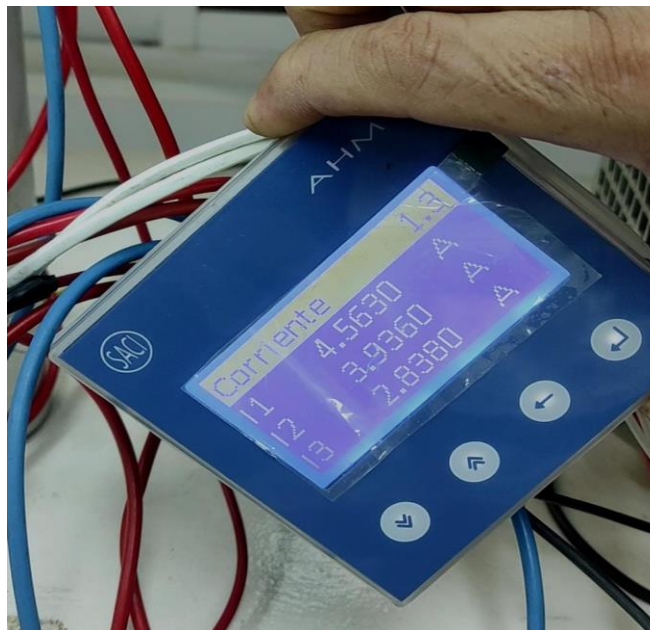
Figura 16. Corriente del analizador AHM1
