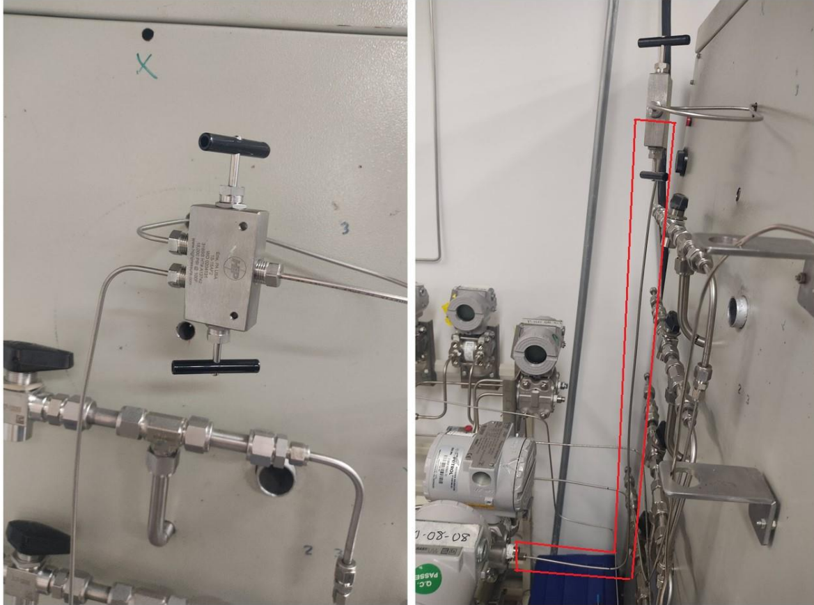
Figura 46 Conexión electroválvulas con válvula 3 vías
