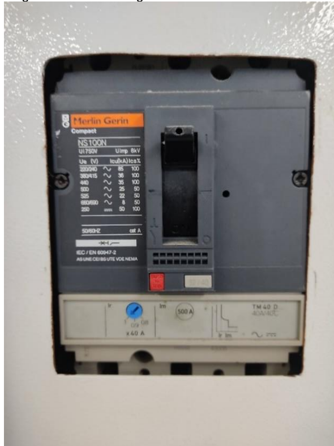
Figura 60 Protección general del tablero de distribución
