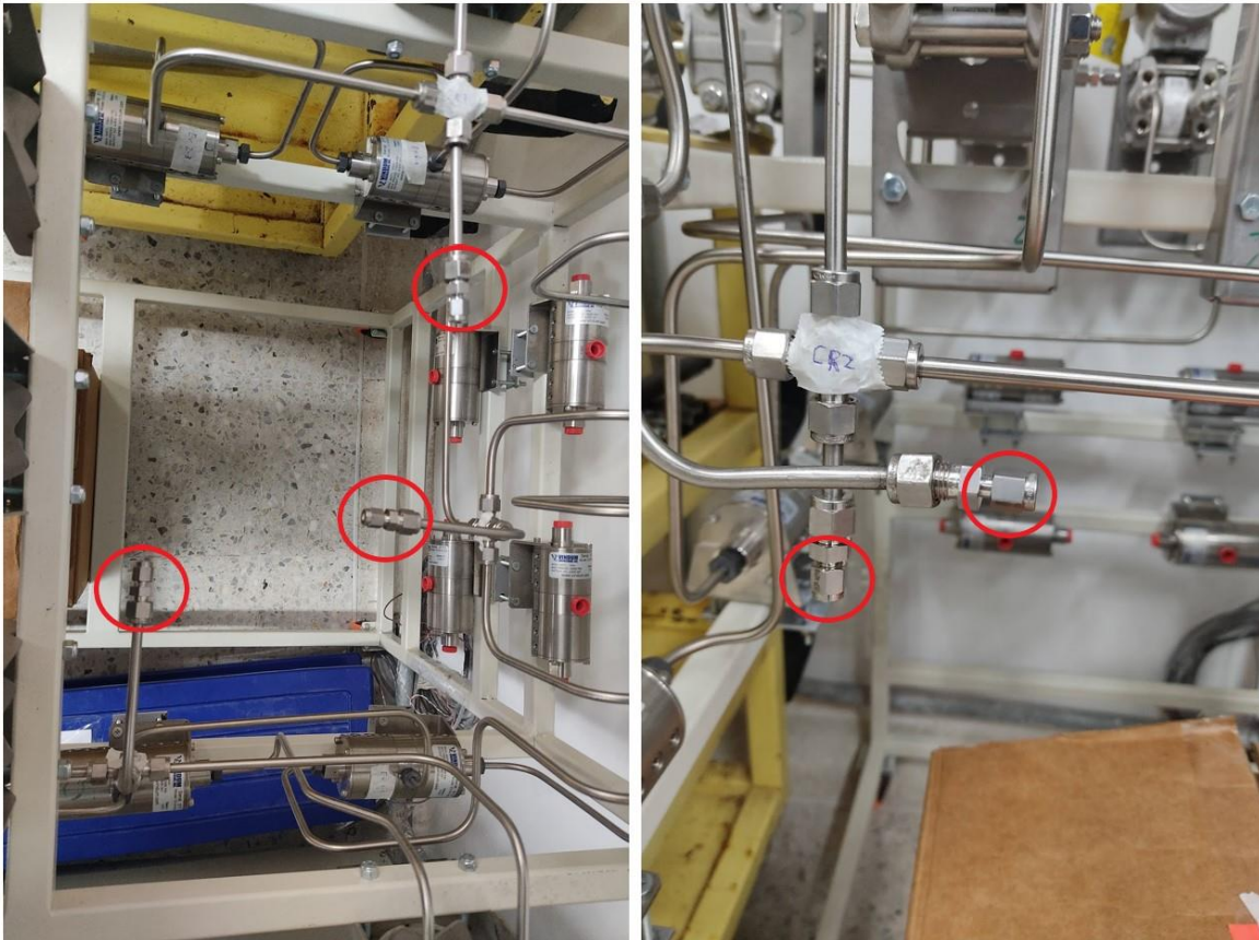
Figura 42 Reducción de tubería de 1/4 a 1/8
