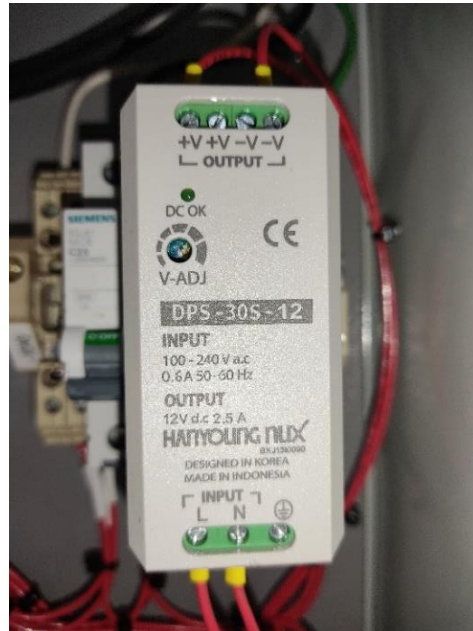
Figura 64 Fuente de alimentación de las electroválvulas
