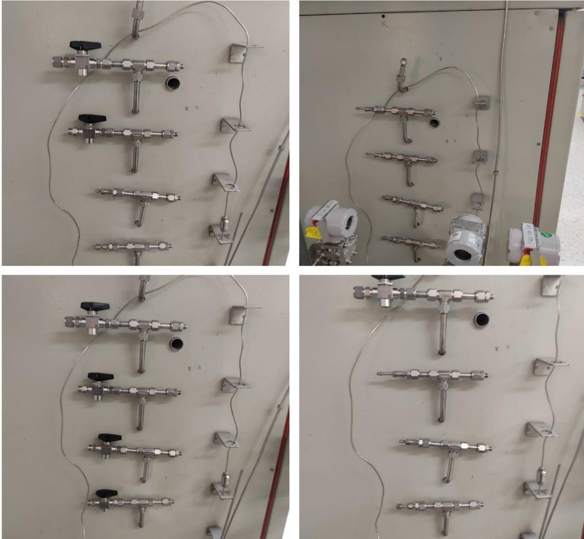
Figura 39 montaje válvulas 3 vías para la toma de muestras
