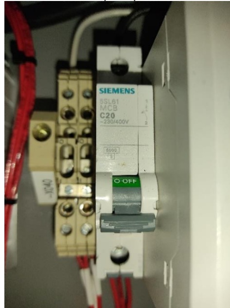
Figura 63 Mini breaker de 20 A para protección del tablero de control
