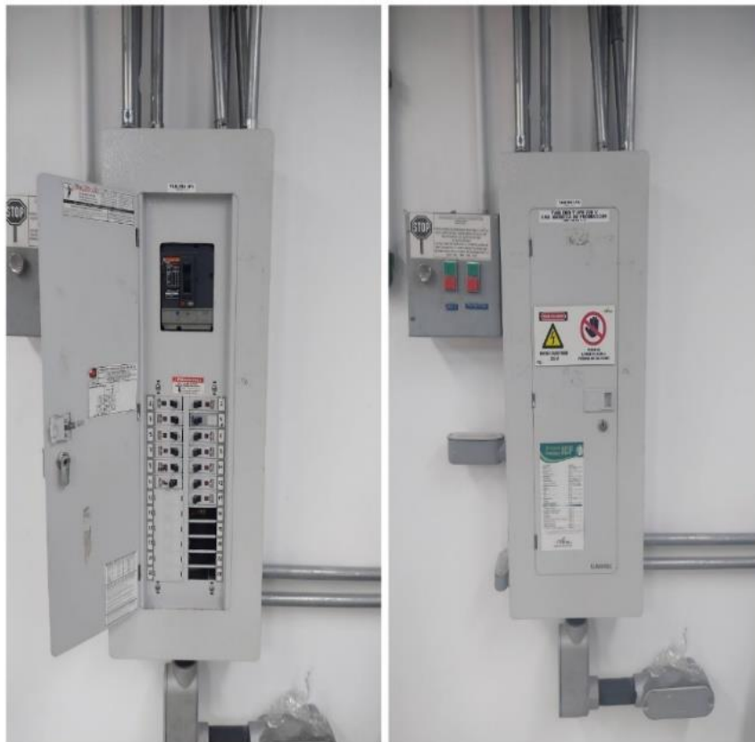
Figura 58 Tablero UPS del laboratorio de química de producción
